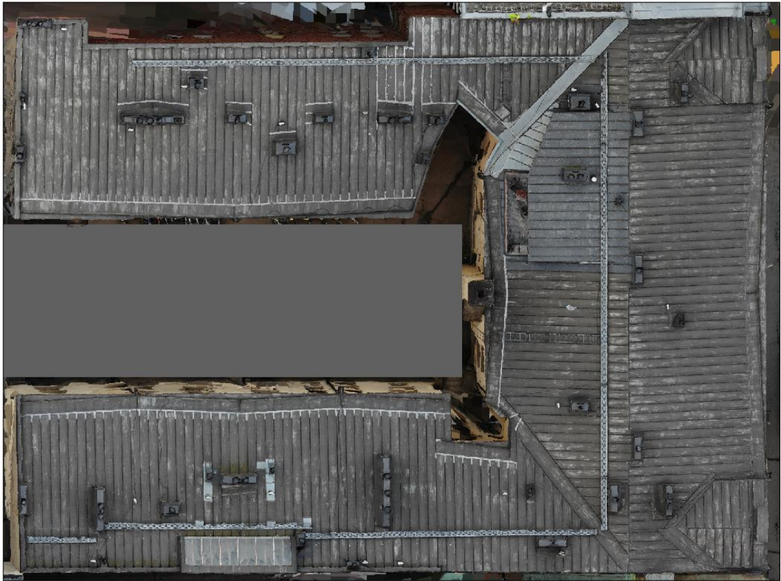
Kuva 16. Map Wizard toiminnolla tehty 2D-tasokuva vesikatosta. Tuntemattomasta syystä vesikatto ei ole aivan suorassa, vaan hormien kyljistä ja julkisivuista näkyy osa viistosti.
