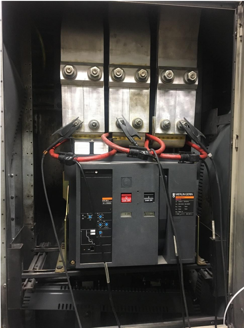
KUVA 6. Mittausten kytkentä pääkytkimellä
