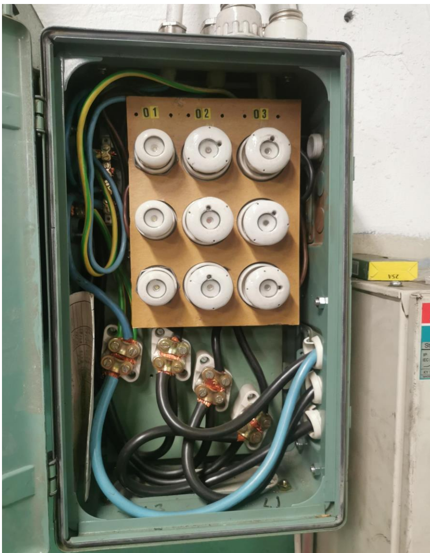
Kuva 1. Alakeskus, jossa puutteellinen suojaus
