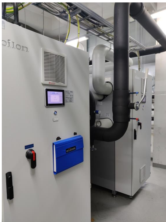
Kuva 9. Helen Oy:n omistama (Oilonin lämpöpumppuratkaisu Helsingissä 2021).
