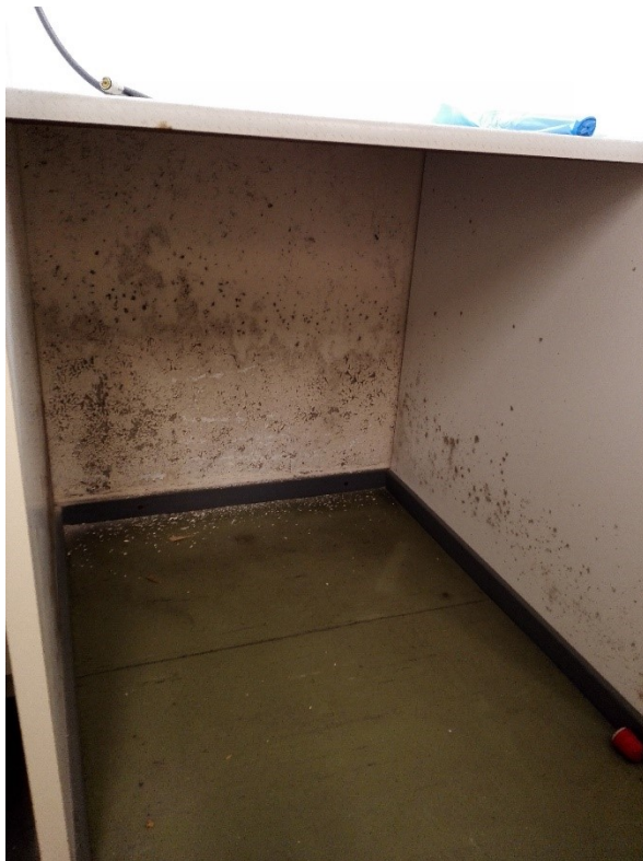
KUVA 8. Kosteusvaurioitunut kaluste (Pärnänen 2019)
