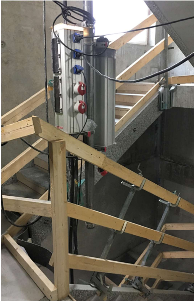
KUVA 2. Sähkökeskus portaikossa (4, s. 17.)
