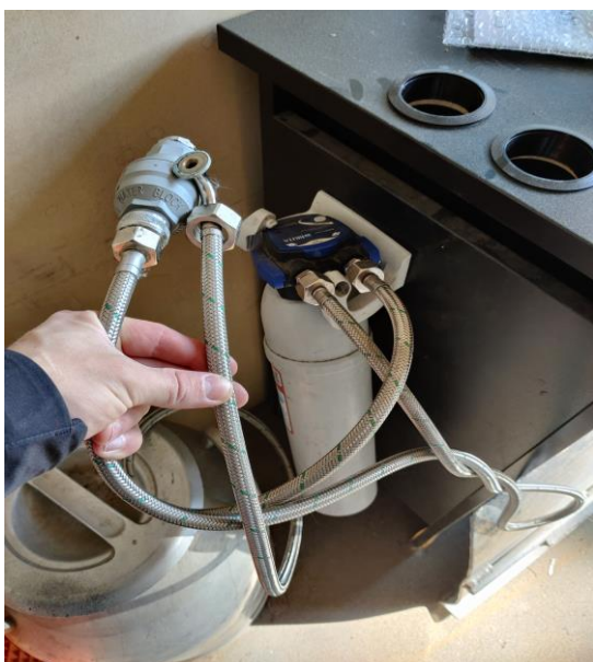
Figur 17, Det gamla sättet att koppla in vattnet
