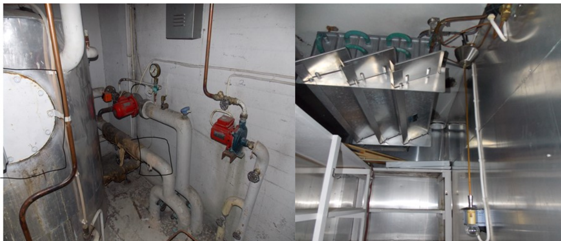
KUVA 12. Asbestia eristeissä ja luukussa sekä kylmäkoneet (Tumanovich 2021, CC BY-NC-ND)
