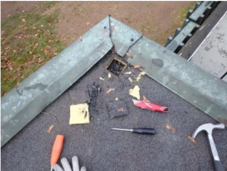
Kuva 2 Näyte 3, rakennusaikaisen vesikatteen bitumia. Näyte ei sisällä asbestia. Näytteen ei PAH- pitoisuuksien raja-arvot eivät ylity.
