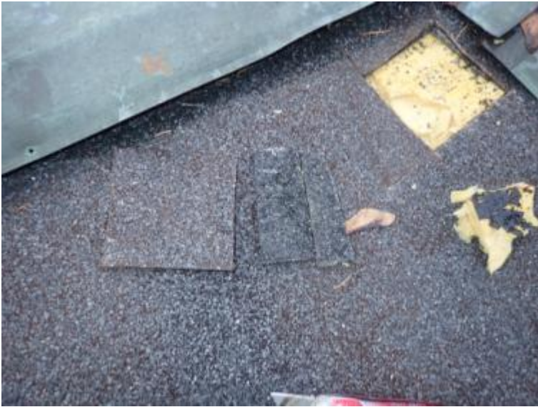
Kuva 1 Näytteet 1 ja 2, vesikatteen pinta- ja pohja-kermiä. Näytteiden PAH- pitoisuuksien raja-arvot eivät ylity.
