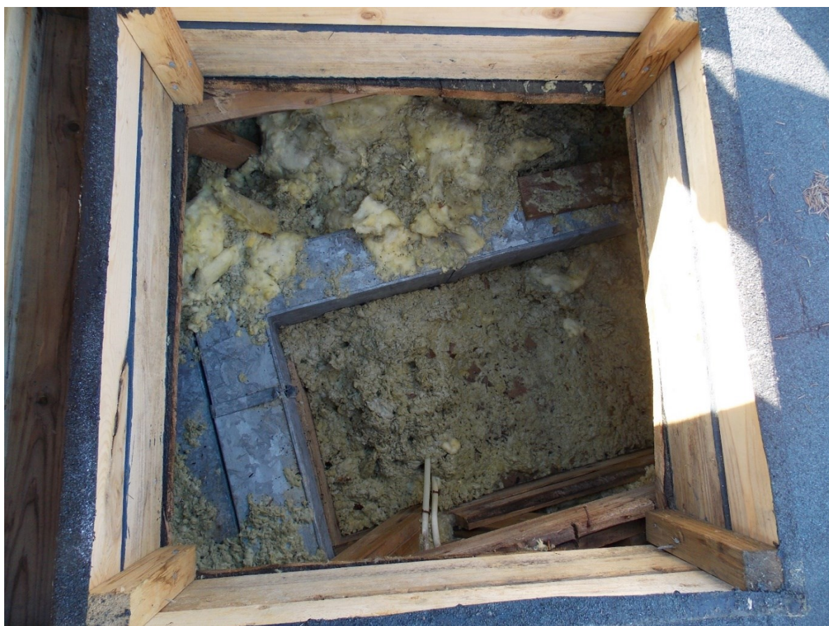
KUVA 3. Asbestin sijainti putkirasioissa (Tumanovich 2021, CC BY-NC-ND)
