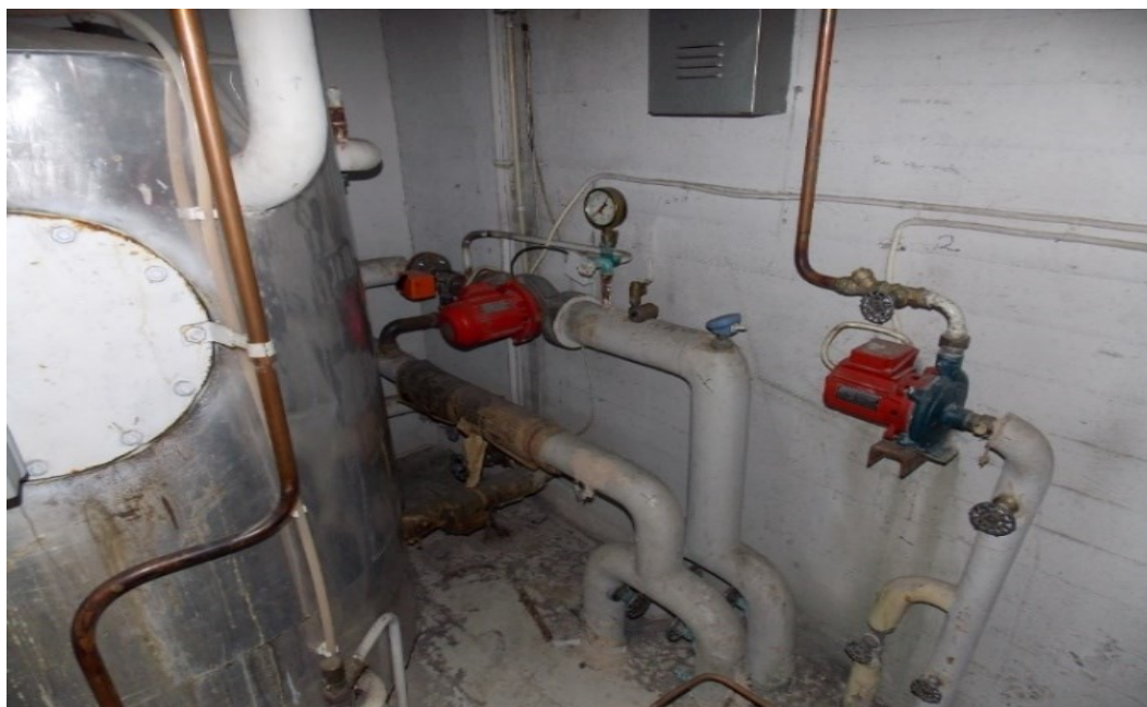
KUVA 1. Lämmönjakohuone (Tumanovich 2021, CC BY-NC-ND)
