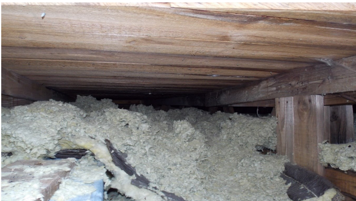
KUVA 8. Vesikatto sisäpuoli (Tumanovich 2021, CC BY-NC-ND)
