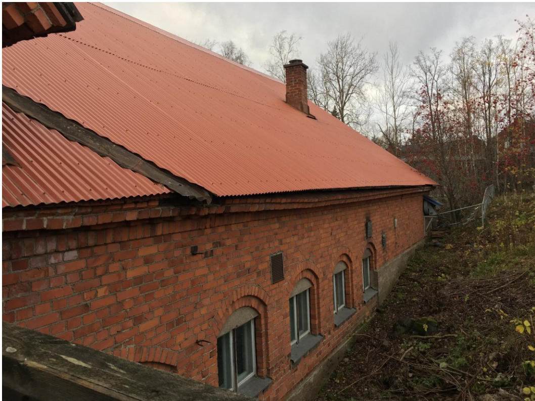
KUVA 17. Navetan nykyisen sisäänkäynnin vieressä tiiliräystä on katon palamisen takia pullistunut ulospäin.
