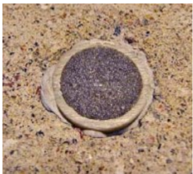
KUVA 14. Vaihtoehtoinen tapa, jossa näkyy myös lämpötilavaihtelujen tasaamiseksi laitettu eriste. Yläpää tulee lisäksi tiivistää kitillä (RT 103333 Betonin suhteellisen kosteuden mittaus 2021)
