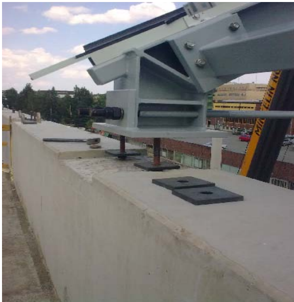
Kuva 7 Peruspulttien reiät väärässä kohdassa teräsrakenteessa
