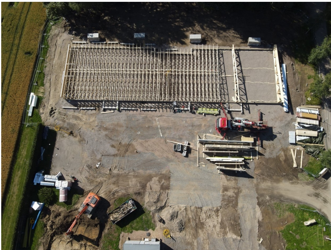
Kuva 27. Vesikattolohkojen rakentamista sokkelin päällä. Vesikaton tekoon tarvittavat materiaalit vievät paljon tilaa rakennuksen ympärillä, joten on hyvä, että tämä työvaihe on tehty ennen muiden töiden aloittamista. Tässä kohteessa maanrakennustyöt oli saatu suurelta osin tehtyä jo aikaisemmin.
