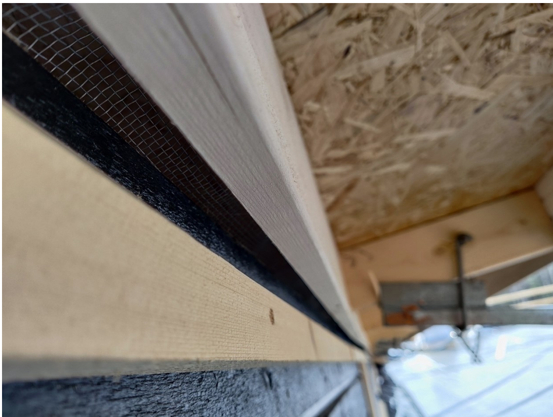
Kuva 25. Pieneläinverkko tuuletusraossa. Ulkoseinässä kiinni naulattuna myrskyrima, joka estää tuulen ulkoseinää ylöspäin puhaltaman lumen ja veden pääsyn yläpohjaan. Taustalla nähtävissä myös kattokaiteiden kiinnityspeiraate.
