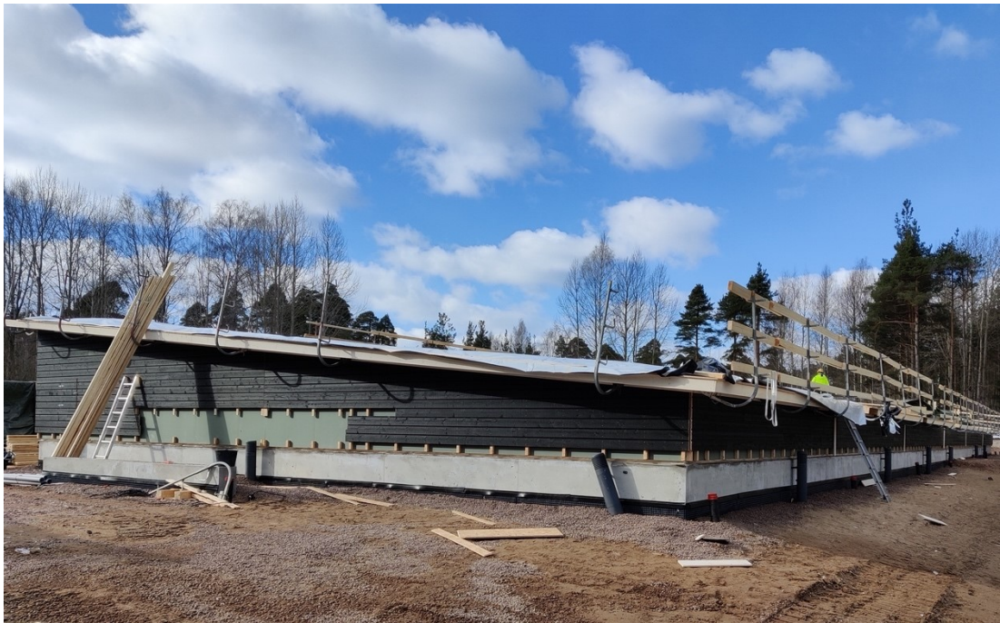
Kuva 26. Kattokaiteiden asennus käynnissä. Katon etuosalla käytettävä telineitä tai valjaita yli 2 metrin korkeudessa työskenneltäessä, muualla katolla tässä työvaiheessa työskenteleminen vaivatonta verrattuna katon rungon päällä tekemiseen.
