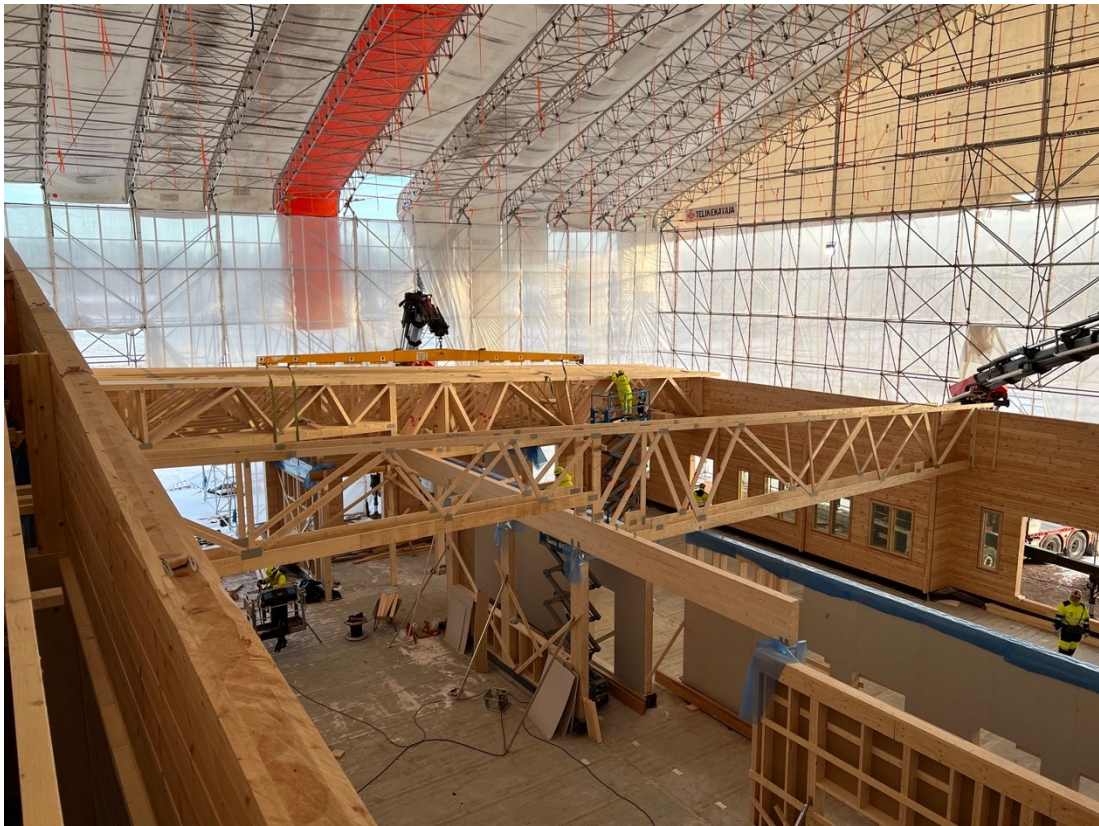
Kuva 28. Sääsuojan seinämiin oli tehtävä hiab-auton mentävät aukot, jotta niillä pääsi sääsuojan sisään ristikoiden nostoa varten. Kuvassa näkyvillä molempien hiabien nostupuomit sekä kaksi saksilavanostinta.
