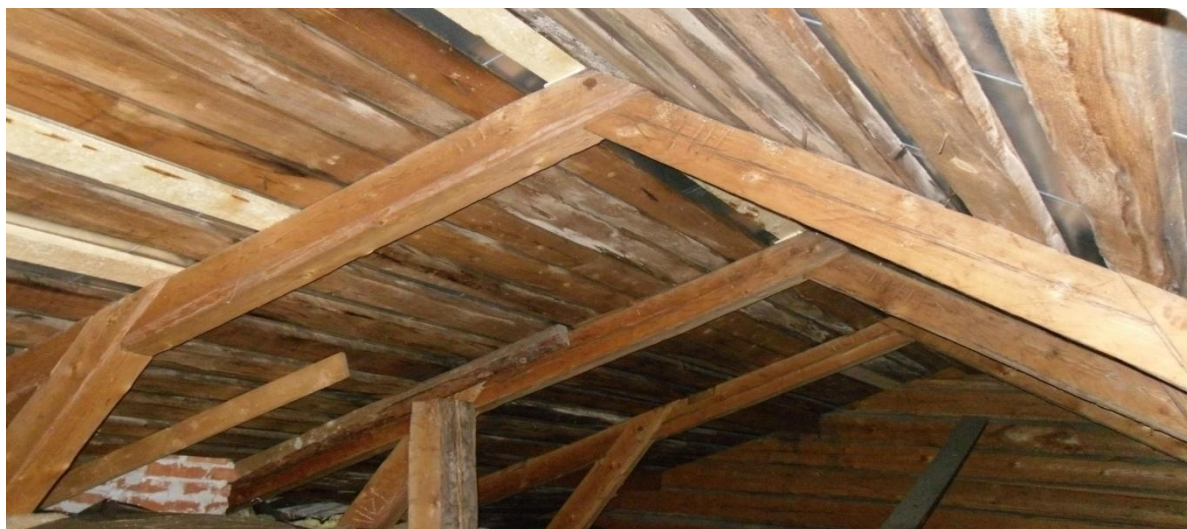
Kuva 2. Kosteuden jättämiä jälkiä ruodelaudoissa
