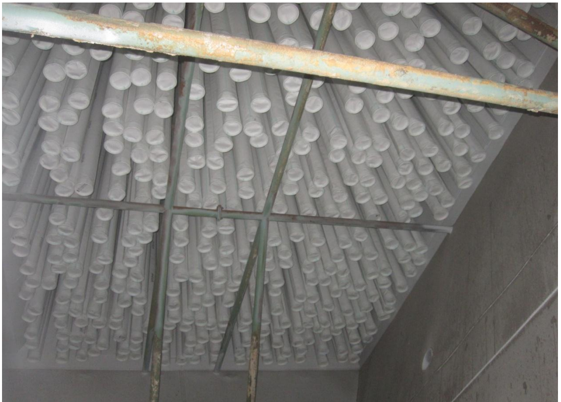
KUVA 8. LA601-letkusuodattimen uusia suodatinelementtejä (valokuva Jarkko Vainikainen)
