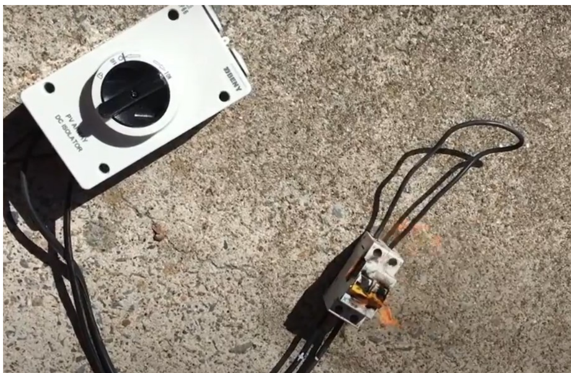
Kuva 12. Virrankestoltaan liian pieni DC-kytkin heti erotuksen jälkeen. [10.]
