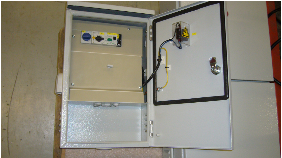
Kuva 12. Moottorisuojakytkimellä ja väliseinäisellä kotelolla toteutettu kokonaisuus.
