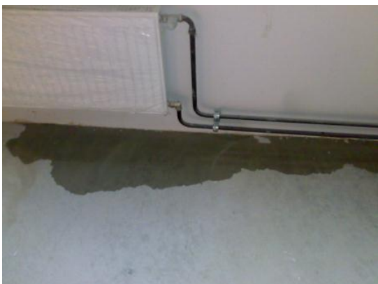
Kuva 4 Patteri oli vuotanut päivän uudisrakennustyömaalla. Asiaan ei oltu reagoitu. Kuva Harri Koponen, 2008
