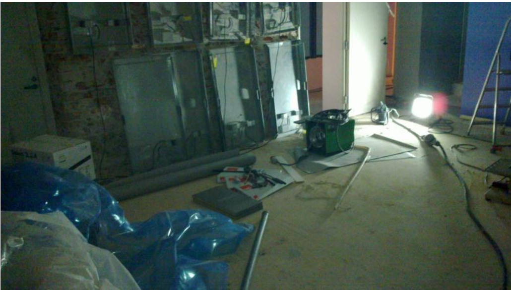
Kuva 7. Rakennustyömaan huone, joka oli vastaavan työnjohtajan mukaan valmis maton asennukselle. Kuva Harri Koponen, 2010.
