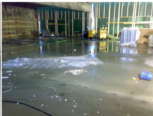
Kuva 5 Kuvan työmaan lattia-asennukset oli määrätty aloitettavaksi 4 viikon päähän kuvanottohetkestä. Kuva Harri Koponen, 2007
