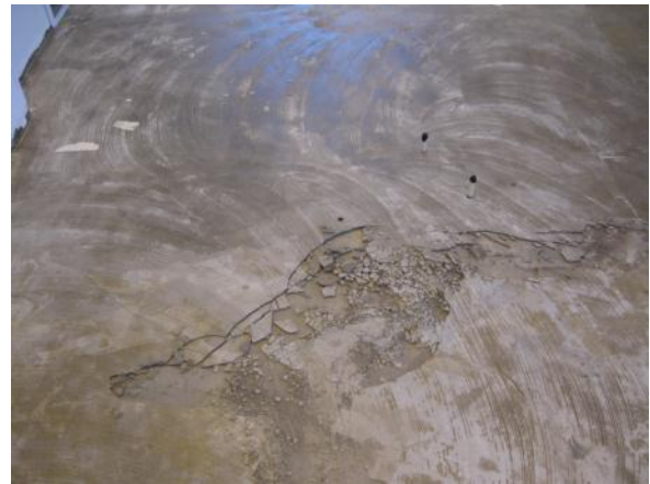
Kuva 2 Tasoitevaurio tuli ilmi maton irrottamisen jälkeen. Kuva Harri Koponen, 2009
