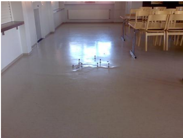
Kuva 2 Betonin kosteuden mattoon aiheuttamia vaurioita. Kuva Harri Koponen, 2009
