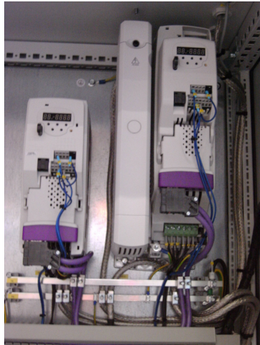
KUVA 38. Taajuusmuuttajat 32U1 ja 32U2.
