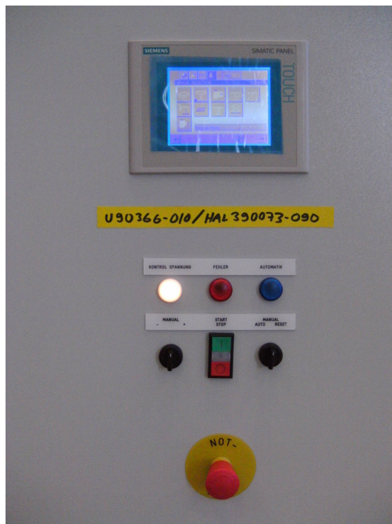
KUVA 40. Ohjauspaneeli, merkkilamput ja käyttökytkimet.
