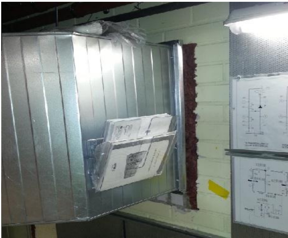
Kuva 9. IV-konehuoneen kanavaläpivienti. (Kuvannut: Kimi Pihlajamäki)
