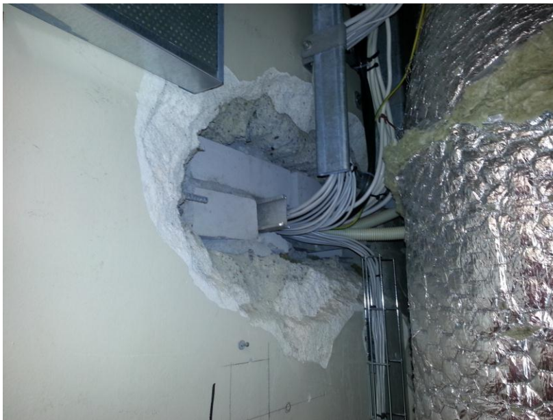
Kuva 11. Osastoiva seinä vailla palokatkoa. (Kuvannut: Kimi Pihlajamäki)
