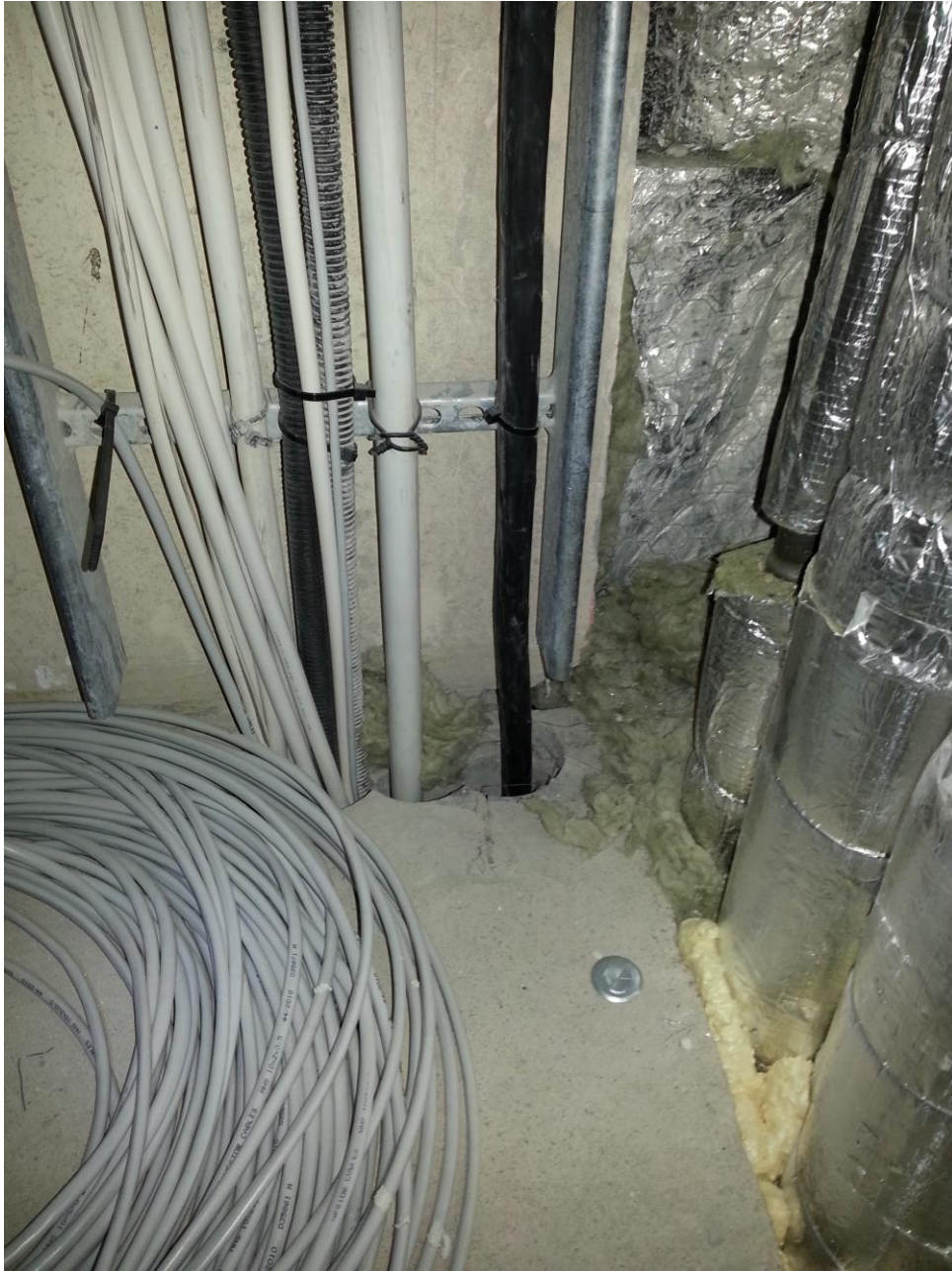
Kuva 16. Osastoivan holvin sähkö-, vesi- ja viemäri­läpivientejä hormissa.
