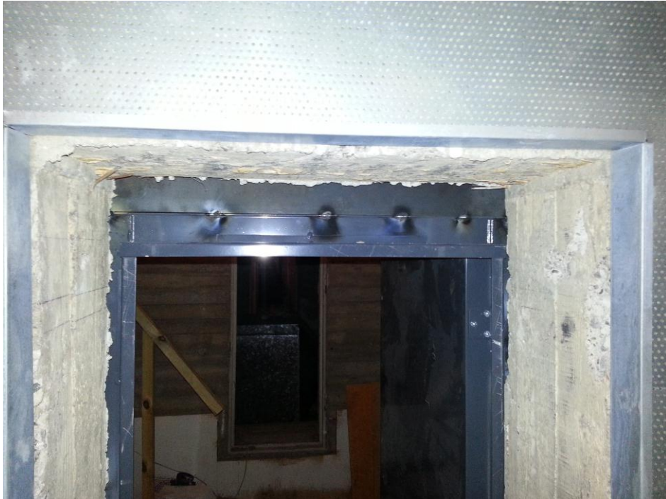
Kuva 19. IV –konehuoneen palo-ovi.
