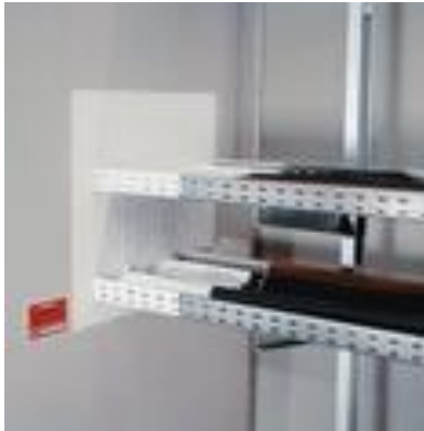
Kuva 2. Osastoivassa seinässä palokatkopinnoitetta. (Hiltin www –sivut 2012)
