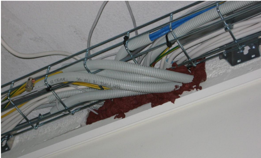
Kuva 10. Sähkökaapeliläpivienti. (Kuvannut: Kimi Pihlajamäki)
