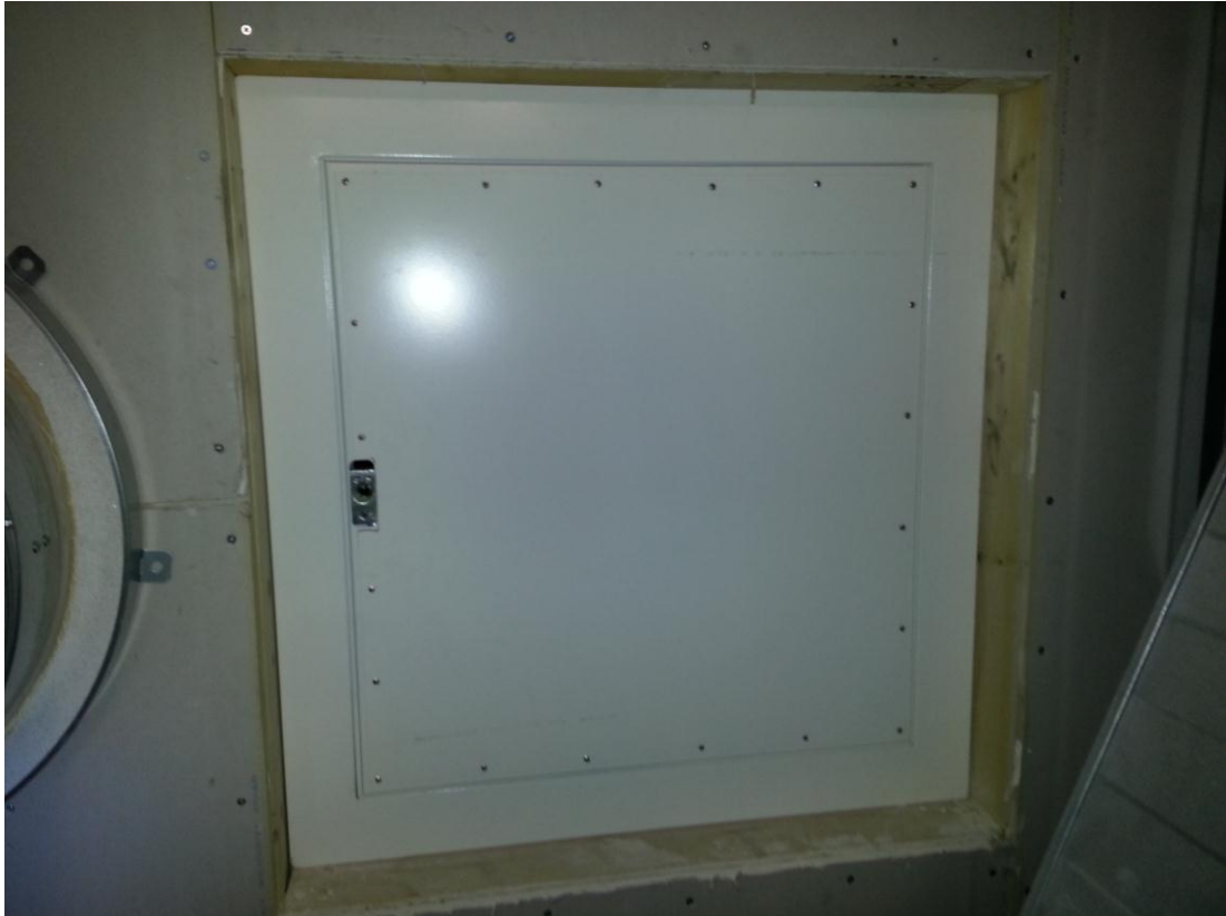
Kuva 18. IV –konehuoneessa oleva paloluokiteltu luukku
