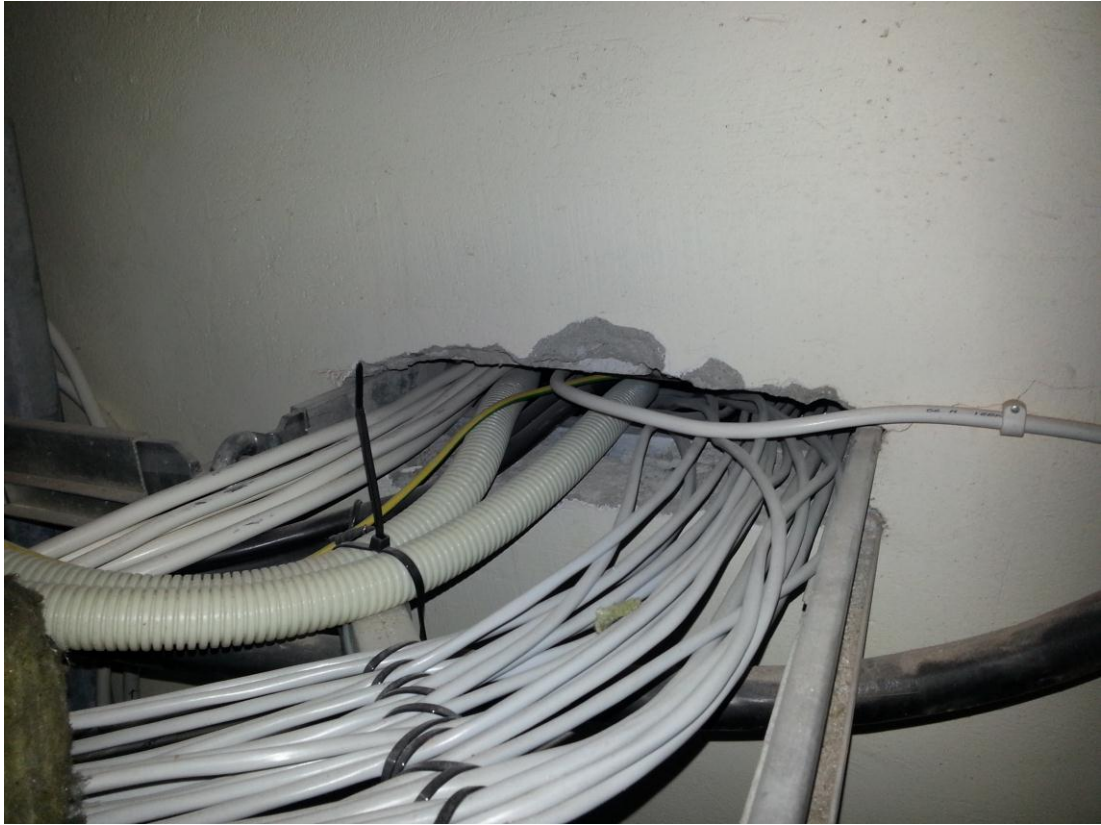
Kuva 12. Sähkökaapeliläpivienti ilman palokatkoa.
