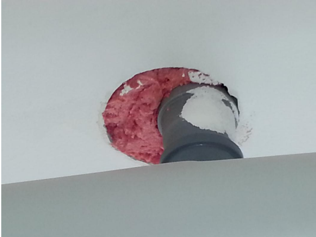
Kuva 17. Punainen, niin sanottu palouretaani ei voi olla osana palokatkoa osastoivassa rakenteessa.
