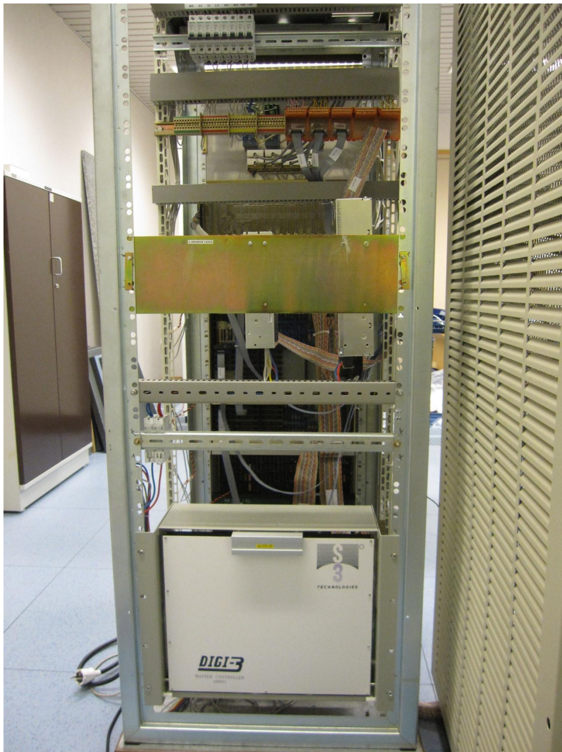
Kuva 3. Testilaitteiston takaosaan on sijoitettu alhaalta ylös lueteltuna Digi-3 Master Controller-yksikkö, päävarokkeet (vasen laita) ja messinkilevyyn kiinnetyt virtalähteet.
