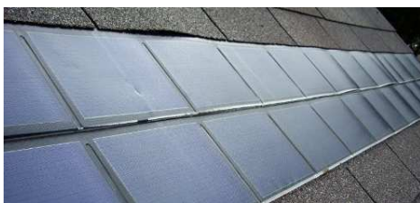
Figur 3. Tunnfilmspanel monterad på ett hustak. /F3/
