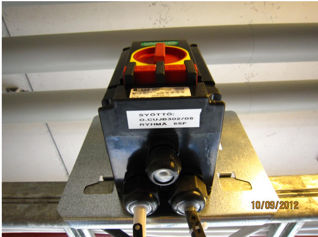
Kuva 3. Turvakytkimen syöttöpisteen merkintä
