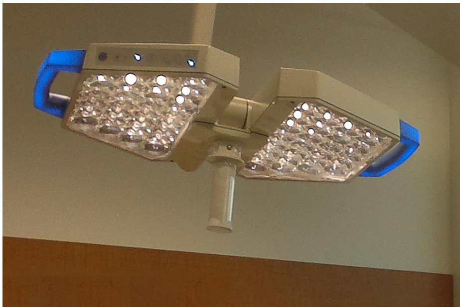
Kuvio 6. Kiinteästi kattoon asennettava valaisin.
