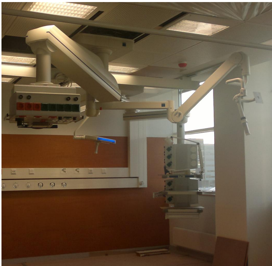
Kuvio 5. Kuvassa vasemmalta katsottuna ensin jalkopään kattokeskus, toimenpidevalaisin, oikeanpuoleinen kattokeskus ja ylhäällä oikealla monitorivarsi potilasvalvontamonitorille.
