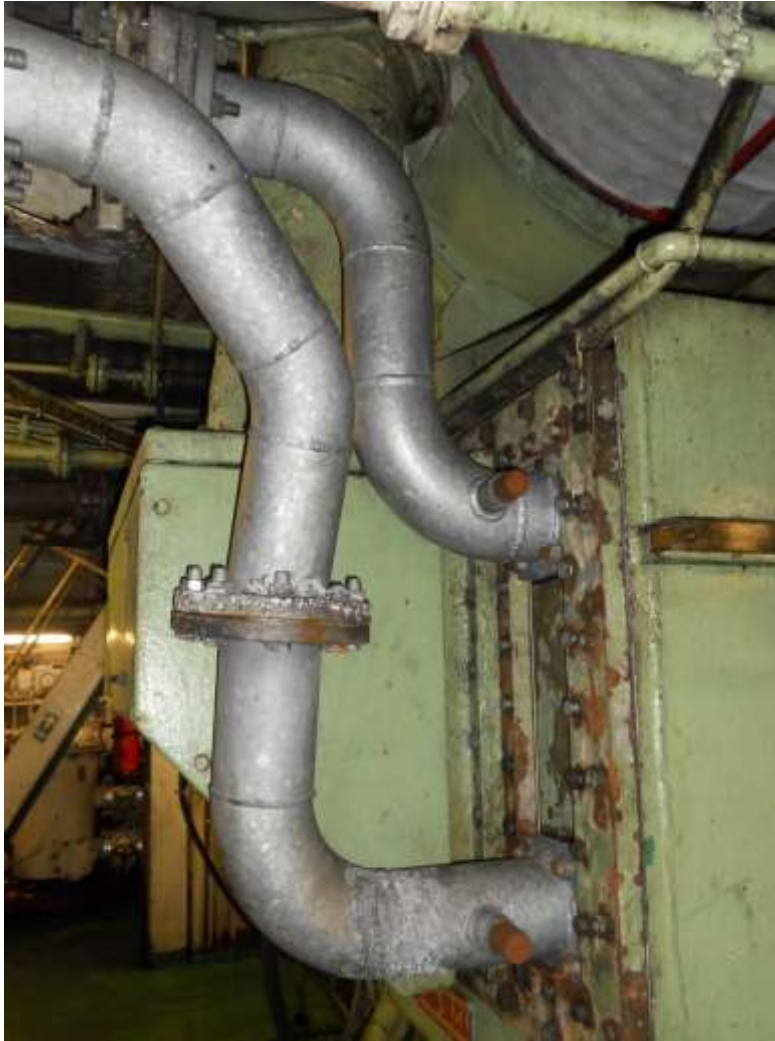
Kuva 14. Pääkoneen ahtoilman merivesijäähdytyskierron putkistoa.
