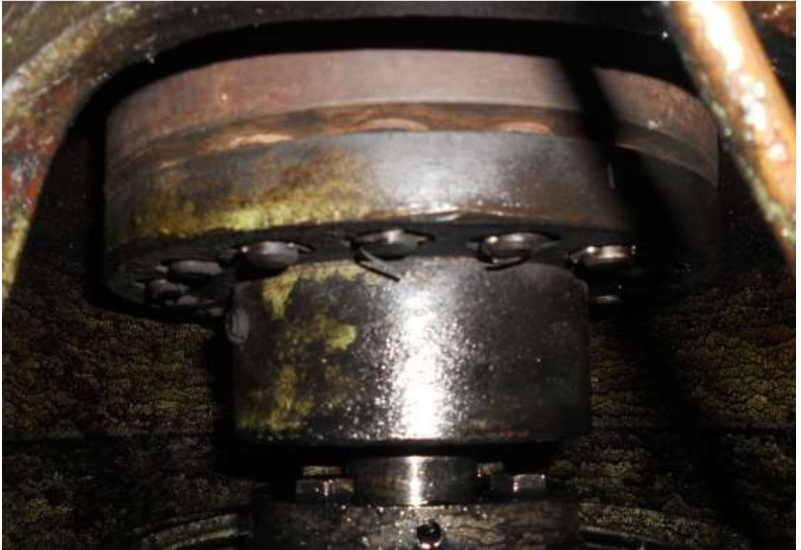
Kuva 2. Pääkoneen voiteluöljypumpun liitos.
