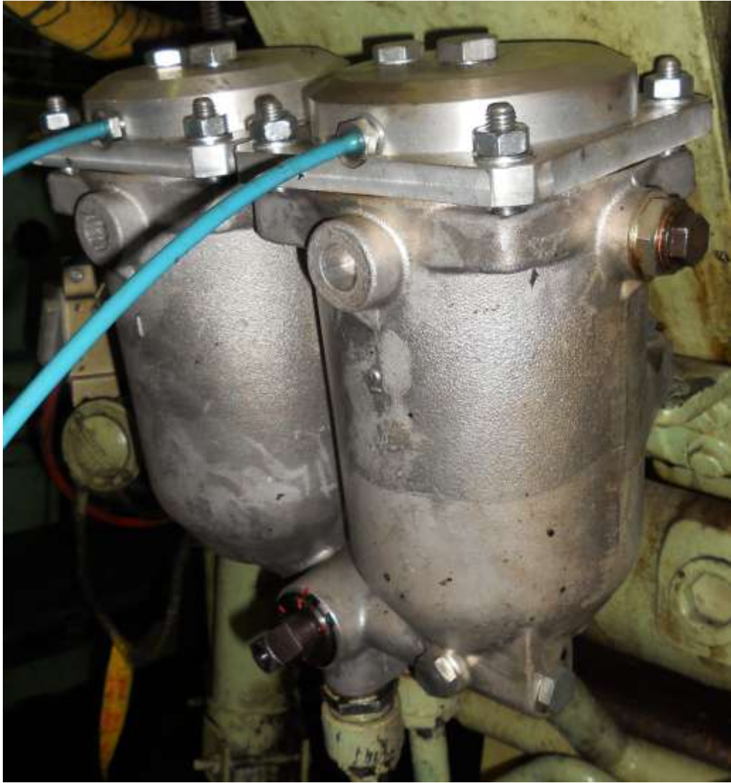
Kuva7. Apukoneen polttoaineen hienofilteripesät.
