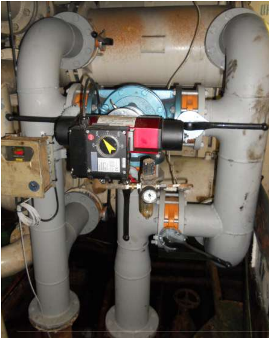
Kuva 12. Apukoneiden jäähdytysveden jäähdytysjärjestelmä.
