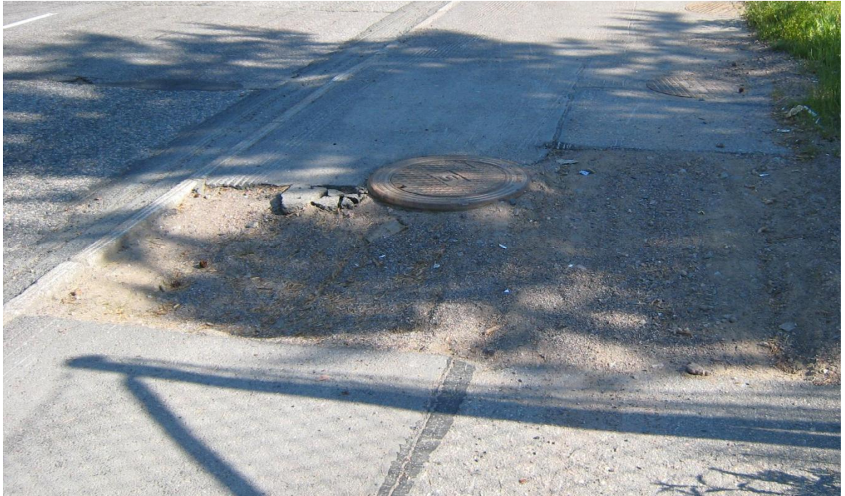
Kuva 12. Jos kaivualueen täyttöä ei ole tehtyä kunnolla, alkaa alue mennä helposti notkolle ja asfaltti saattaa lohkeilla. Eritoten pakkasilla ja sadekeleillä nämä kohteet saattavat mennä jopa vaarallisen huonoon kuntoon.
