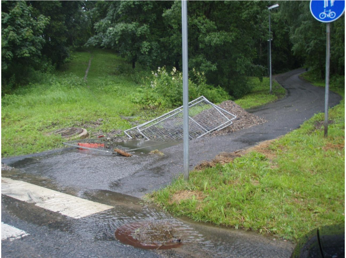
Kuva 11. Auki jätetyt kaivannot ovat joskus todella huonossa kunnossa, jos urakoitsijat eivät seuraa omia kohteitaan.
