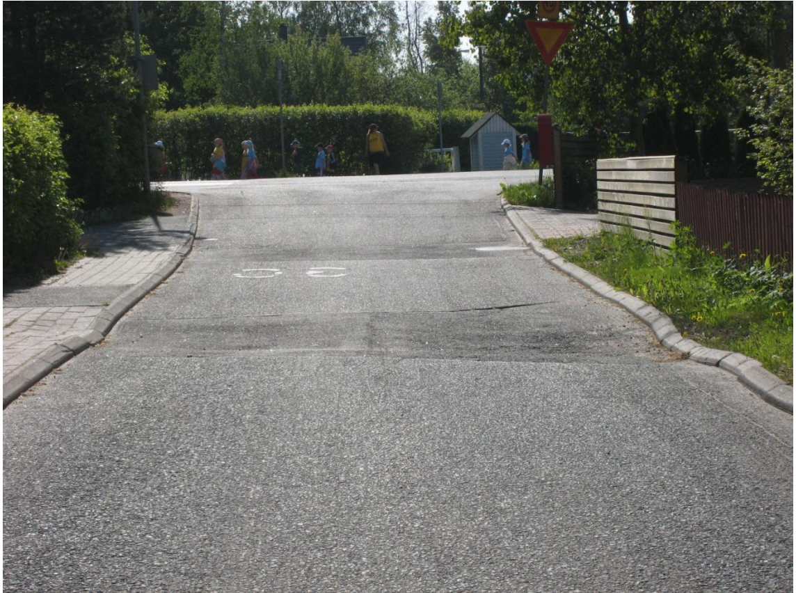
Kuva 9. Huonosti tai vääränlaisella murskeella täytetty kaivanto on painunut.
