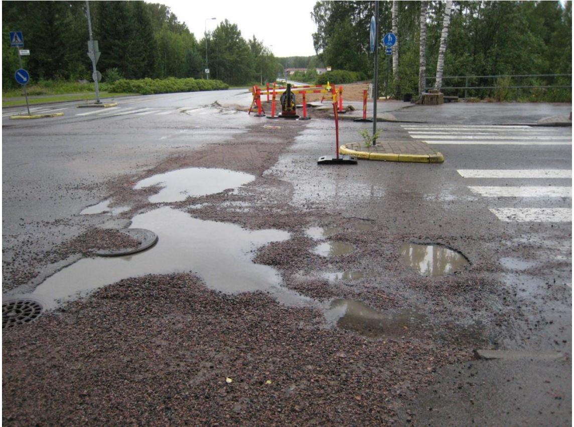
Kuva 13. Vaihtelevat kelit – kuten vesisateet – voivat huonontaa täytetyn kaivannon kunnan nopeastikin. Tämän vuoksi seuranta on tärkeää myös täytön ja päällystykseen välissä.
