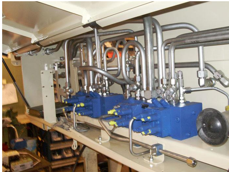
Kuva 5. Kuvassa hydraulilaatikon sisäkuva (Kuva A.Hyökki 2012.)
