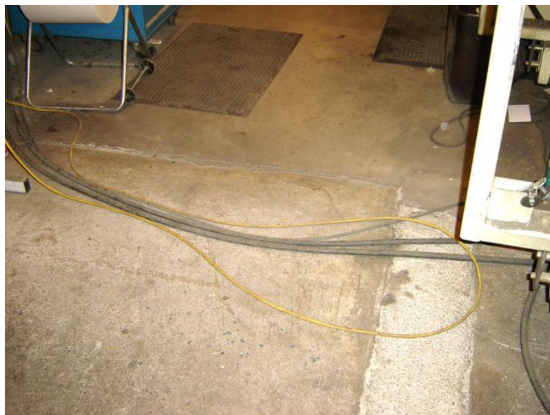
Kuva 10. Lattialla lojuvat sähköjohdot ja paineilmaletkut ovat työturvallisuusriski. (Kuva A.Hyökki 2012)
