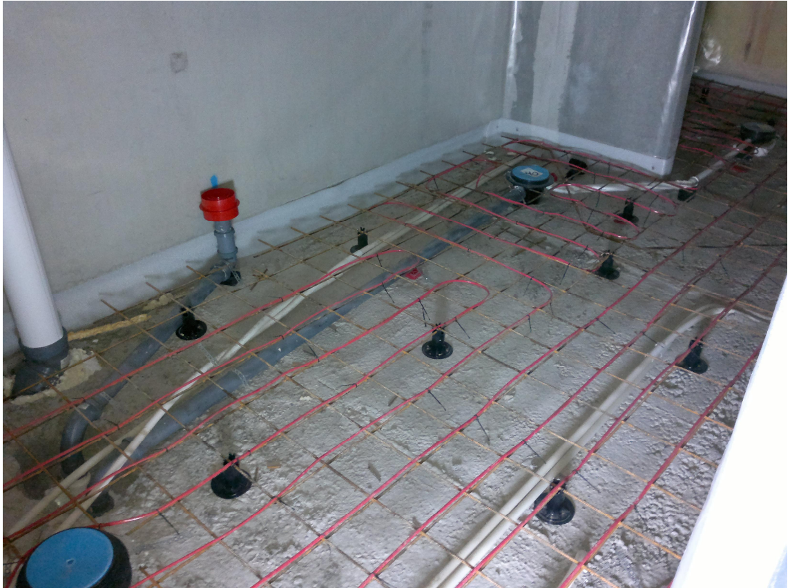
Kuva 1. Lattiarakenteen sisällä olevaa tekniikkaa. (Ahola 2012.)
