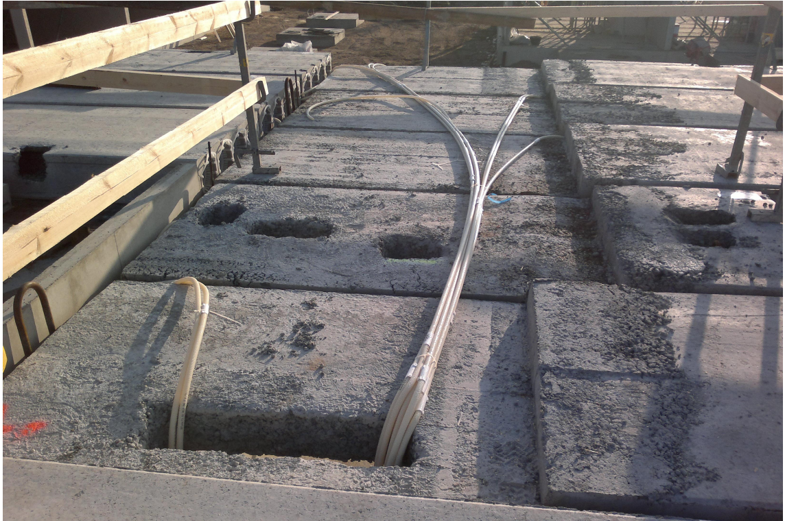
Kuva 3. Märkätilojen kohdalla olevia kolouksia ontelolaatoissa. (Ahola 2012.)
