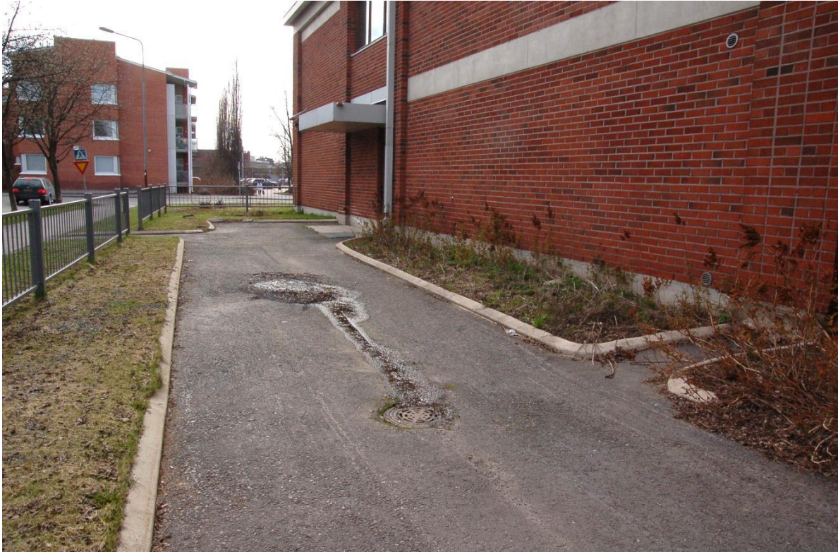
KUVA 11. Seinänvierustan pensastot ovat huonokuntoisia ja kasvavat liian suuriksi
