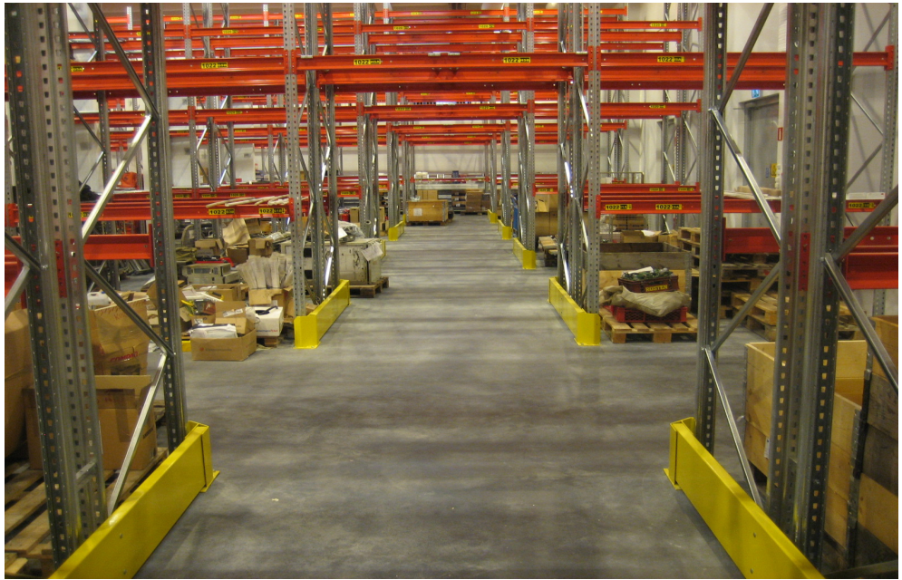
Kuva 12. Uuden Mastertop -pinnoitteen epätasavärisyys havaittavissa.
