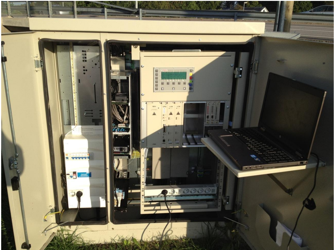
Kuvio 1. Kojekaapin sisällä sijaitseva EC-2 -ohjauskojeisto.
