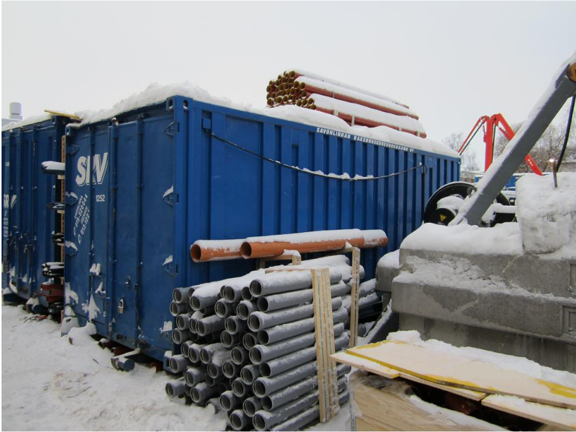
KUVA 10. Putkien varastointi merikontin katolla.
