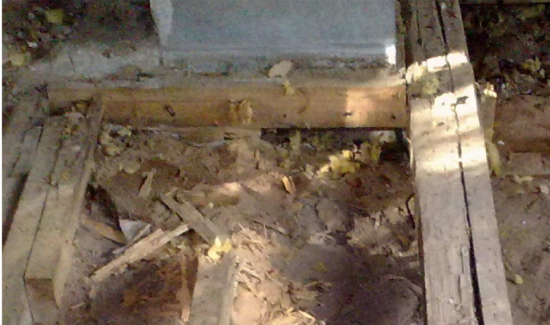
KUVA 7. Piipun ympäristön vaurioita
