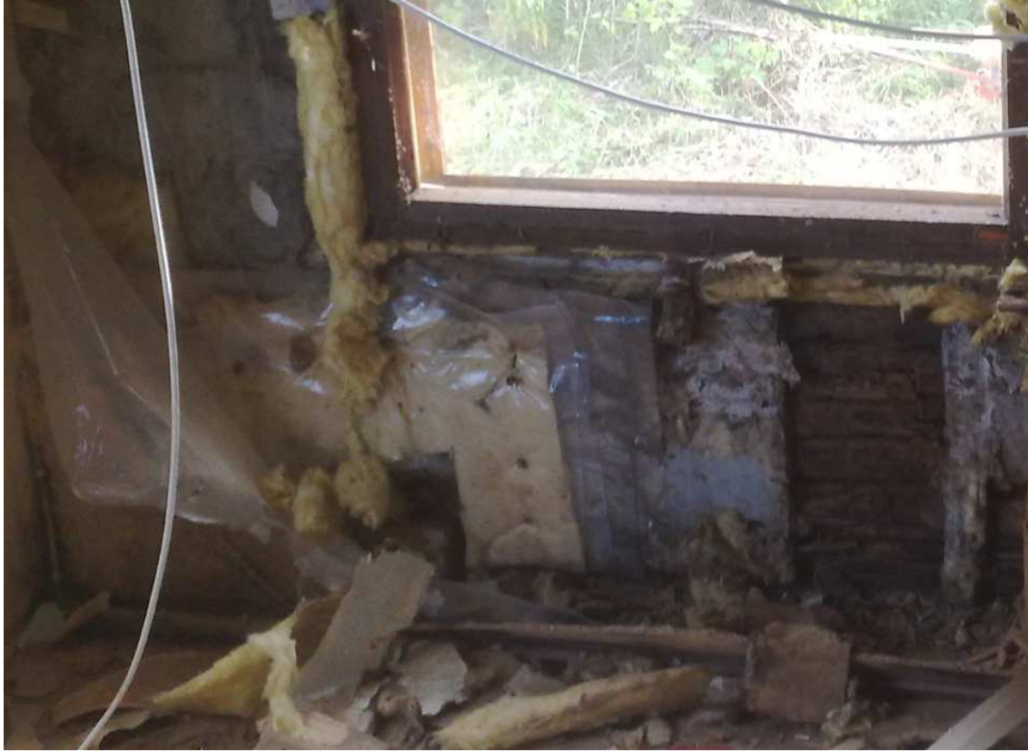
KUVA 9. Lahonnut seinä ja höyrynsulku
