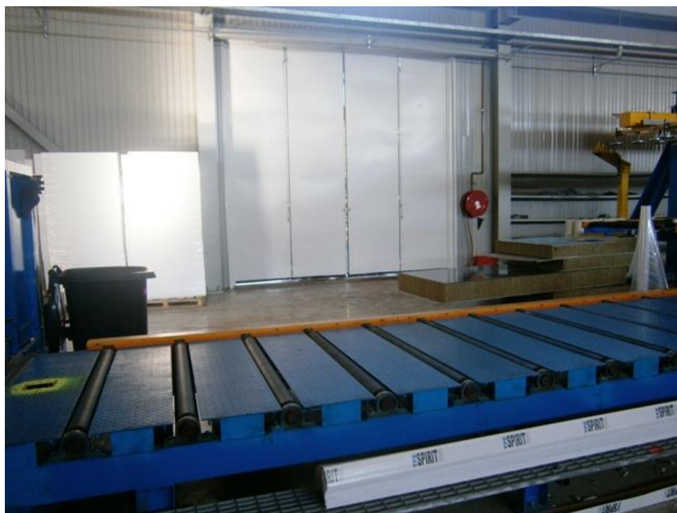
4. Taiteovi, jonka tiivisteissä on lämpövuotoja
