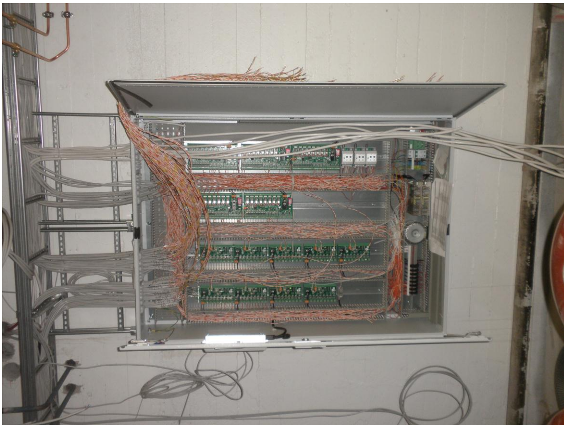
Kuva 15. Kiinteistöautomaatiokeskus ja osa ohjauskaapeleista kytkettynä
