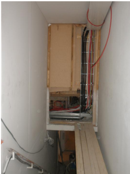
Kuva 17. IV-putkistojen ja sähköjohtoreittien risteilyä
