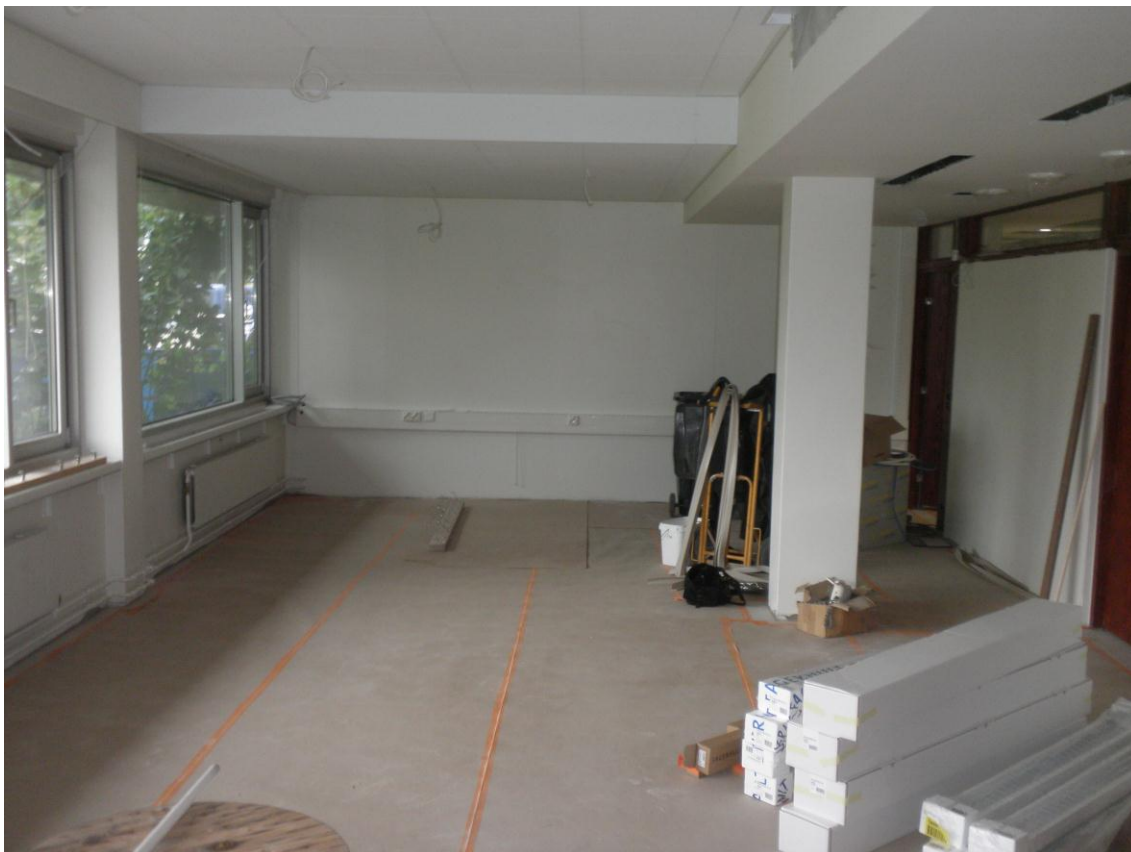
Kuva 20. Kattopintojen korkeusero aiheutti ongelmia valaisinasennuksessa.
