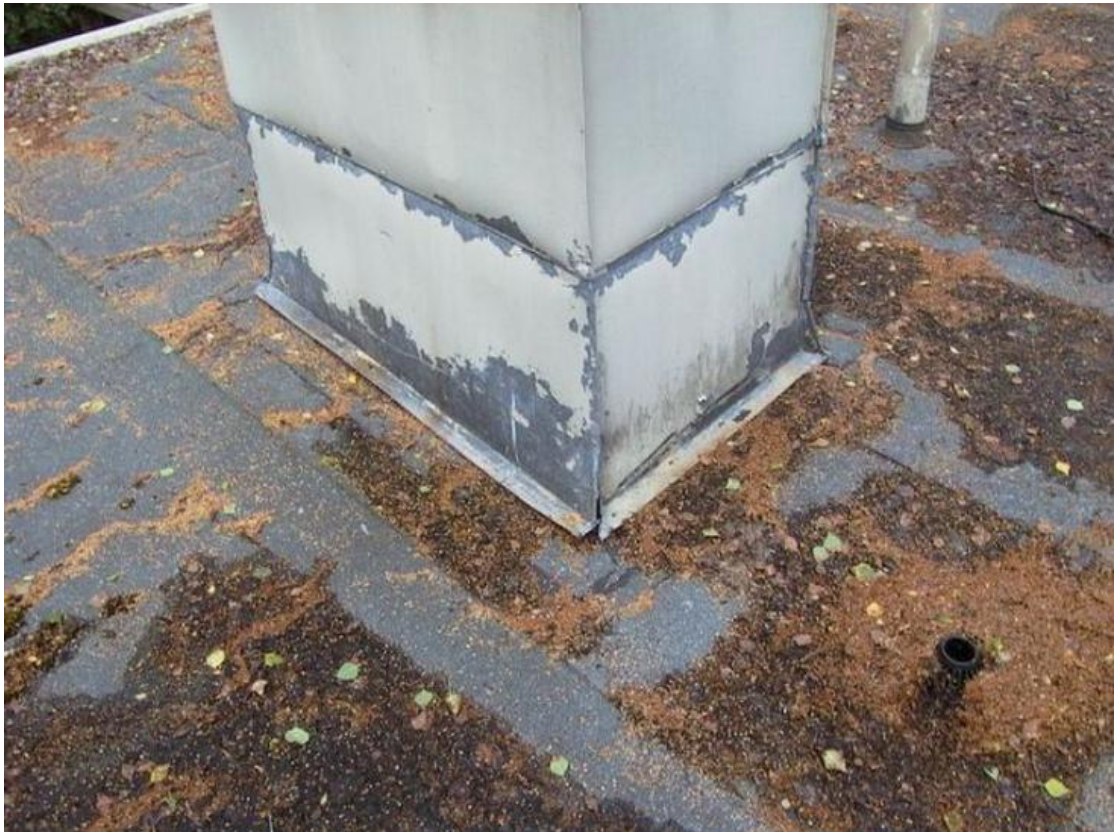
Kuva 16. Huonokuntoisten pellitysten takia rakenteisiin saattaa päästä vettä (Sisäilmäyhdistys 2013.)
