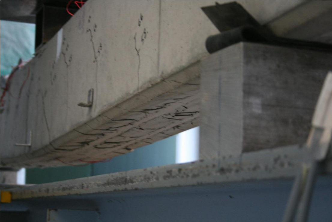
KUVA 31. Halkeamat hiilikuidun ympärillä betonissa. Kuvassa korjattu palkki. Valokuva Atte Heiskanen
