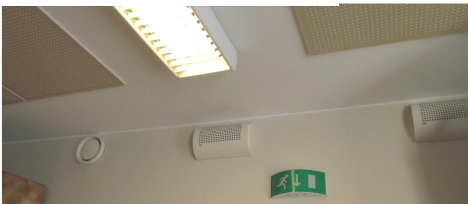
Kuva 7. Heittokuvioon nähden liian lähelle kattoa asennettuja tuloilmahajottajia
