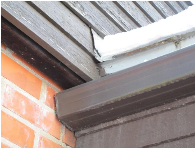
KUVA 31: Ulkoseinän ja katon riittämätön pellitys sekä vuotava räystäskourun pää
