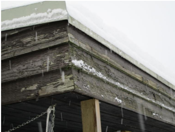
KUVA 15: Puisen räystäsrakenteen huono kunto
