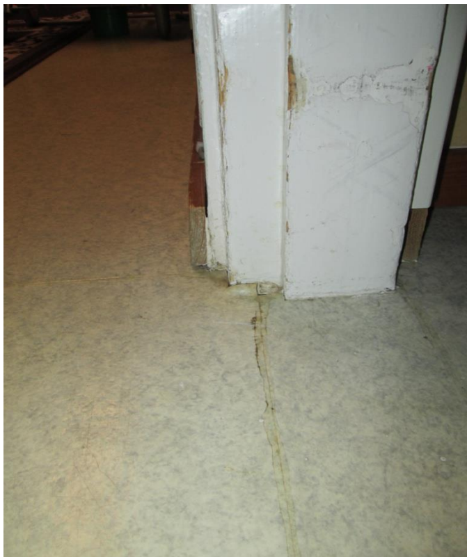
KUVA 38: Muovimaton kuluneet saumat ja sisäoven kulunut karmi
