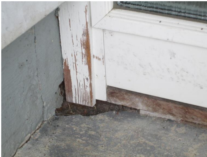
KUVA 50: Porraslaatan kulmasta on lohjennut palanen pois
