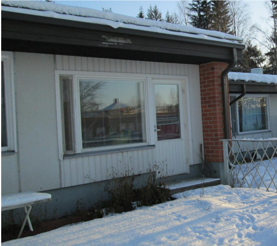
KUVA 25: Asunnon A3 itäjulkisivun maalivaurio räystäässä viittaa yläpohjan ilma- vuotoon
