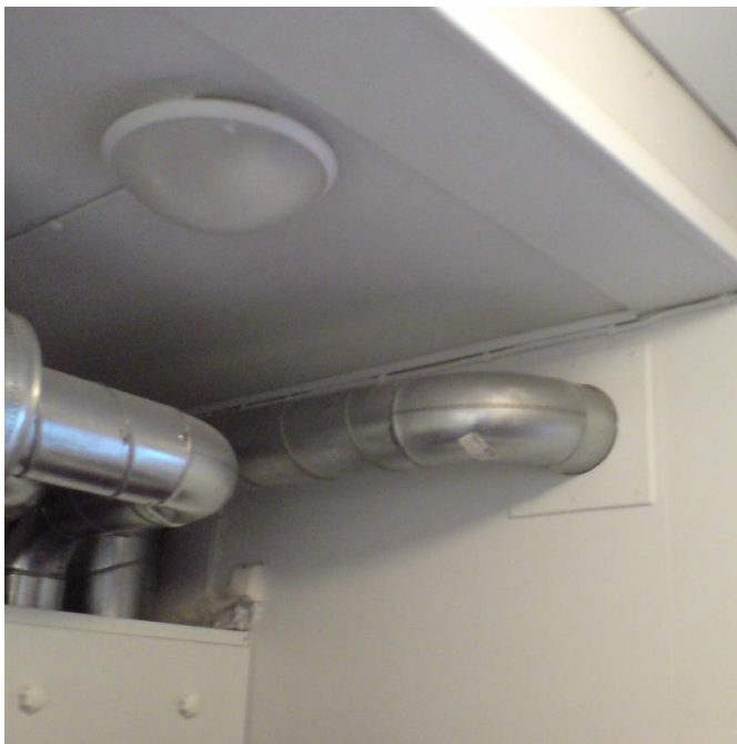
KUVA 49: Koneellinen tulo ja poistoilmanvaihtojärjestelmä
