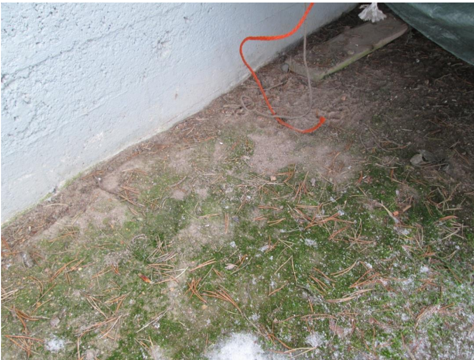
KUVA 2: Sammaloitunutta maata sokkelin vierustalla
