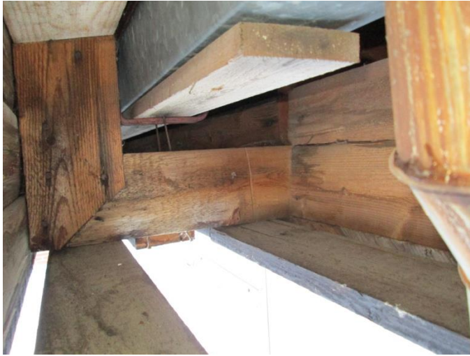
KUVA 35: Piiloräystään puurakenteet ovat kosteusvaurioituneet
