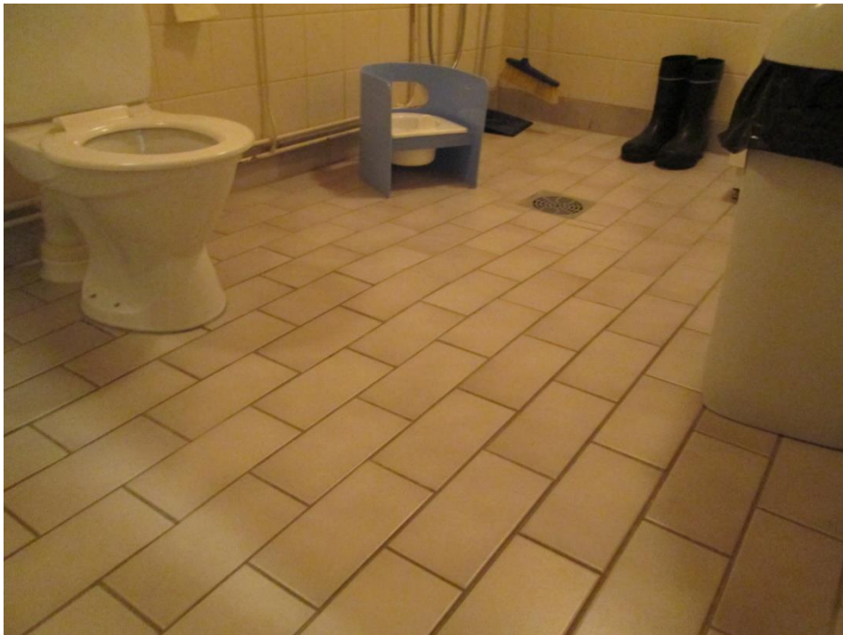
KUVA 42: Lattian kaadot ovat huonot
