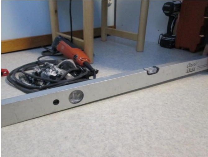
KUVA 36: Vesivaa'an avulla todetaan lattian painuneen metrin matkalla noin 1,5 cm
