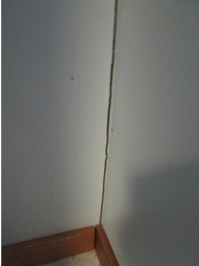
KUVA 16: Keittiön ja olohuoneen välisen seinän halkeama
