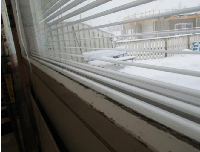
KUVA 40: Ikkunapuitteen maalin irtoamista sisäpuolelta
