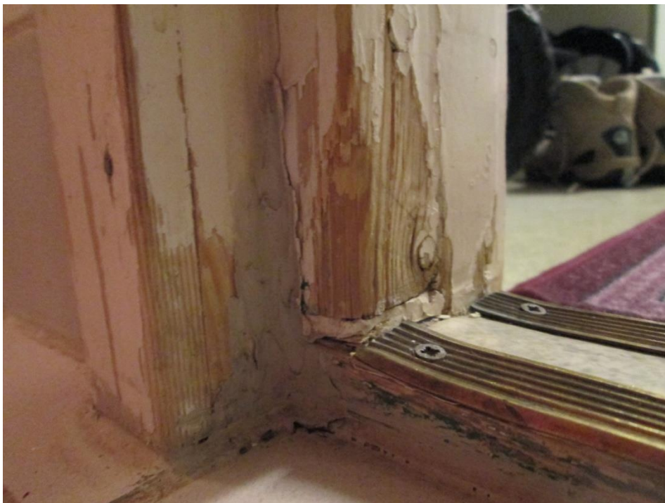
KUVA 44: Kynnys on tummunut ja sitä on yritetty suojata silikonimassalla saumaamalla
