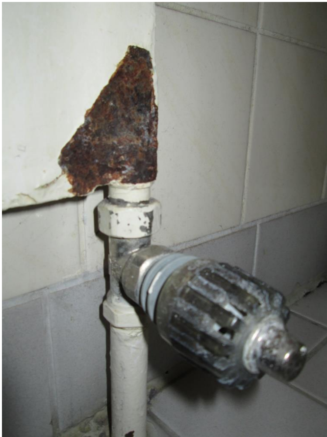
KUVA 45: Wc:n patterin ruostevaurio
