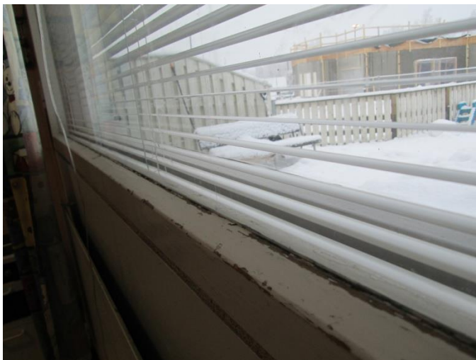
KUVA 17: Ikkunan sisäpuolen pinnoitusvaurio
