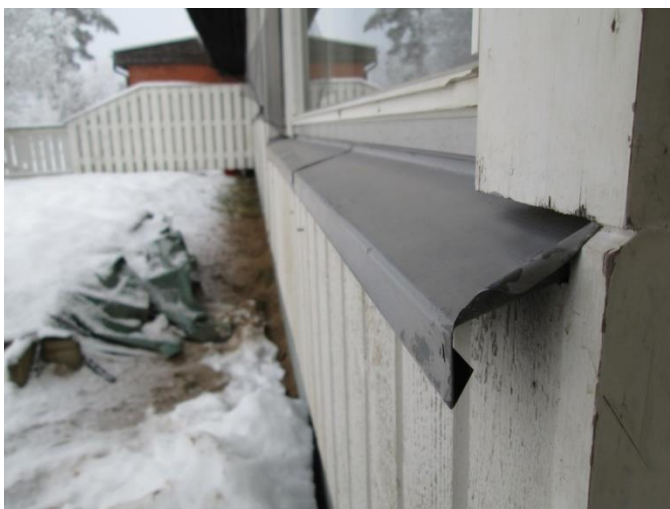
KUVA 15: Lautaverhoilu ja ikkunan vesipelti
