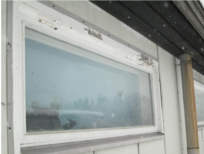
KUVA 14: Valumajälkiä seinän yläosassa ja kittipaikkauksia, ikkunan puuosien maali- vaurioita ja syöksytorven vuotoa
