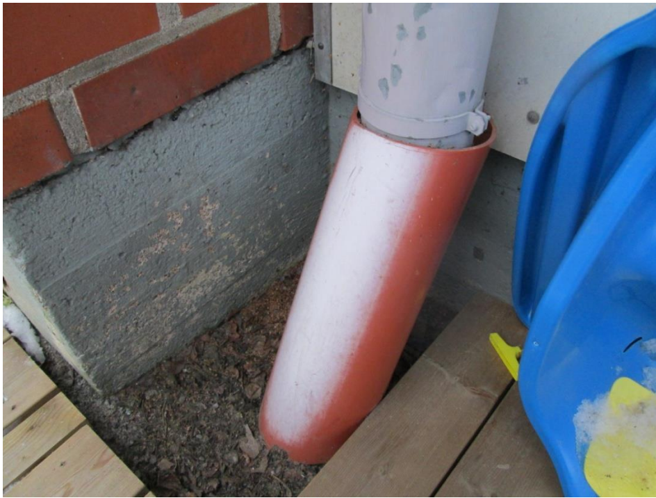
KUVA 3: Sadevesikaivot puuttuvat. Syksytorven lisäpatkka estää vain roiskevedet.
