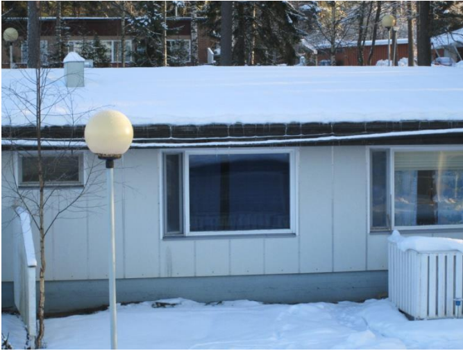
KUVA 32: B-rakennuksen länsijulkisivulla on osittain irronnut räystäskouru
