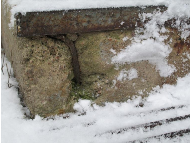
KUVA 51: Porraslaatan raudoitteet ovat näkyvillä ja ruosteessa. Lisäksi teräksinen kulmasuoja on ruosteessa
