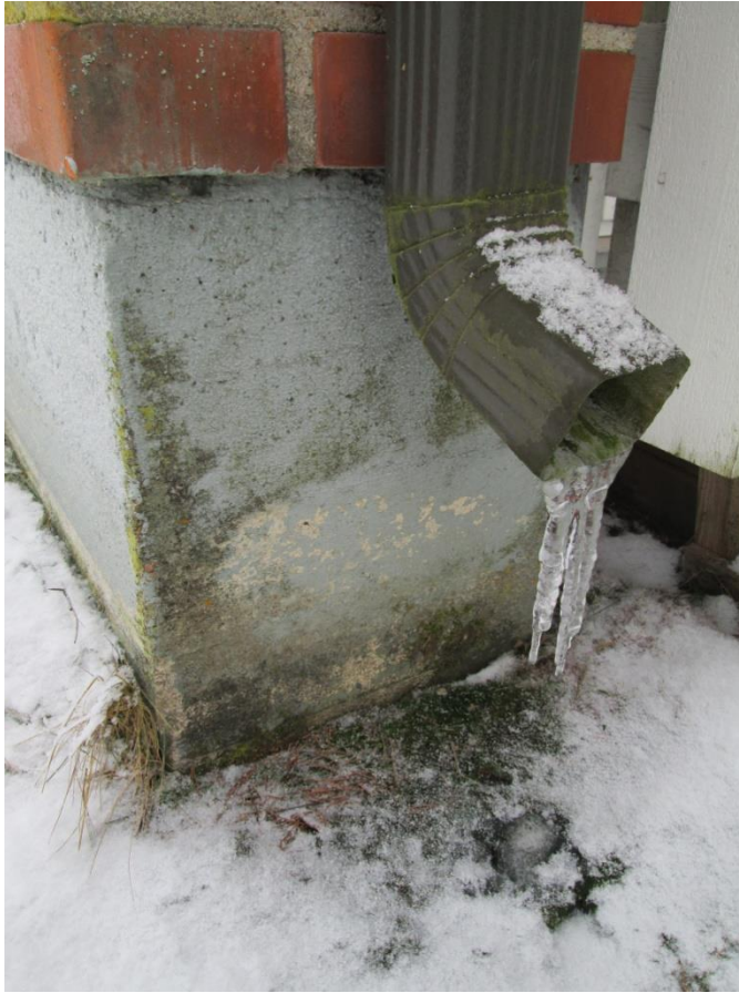
KUVA 7: Sadevedet on johdettu syöksytorvista suoraan maahan
