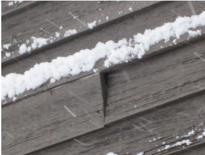
KUVA 28: Lauta on irronnut pontistaan rakennuksen päädyssä
