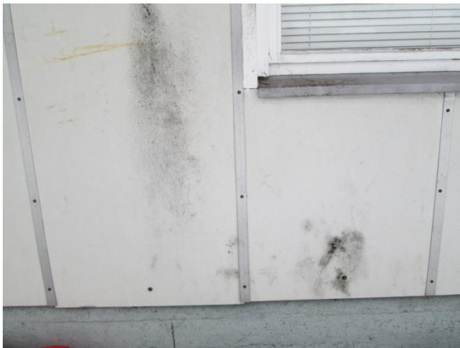
KUVA 10: Mineriittilevyn pinnan homelaikkuja
