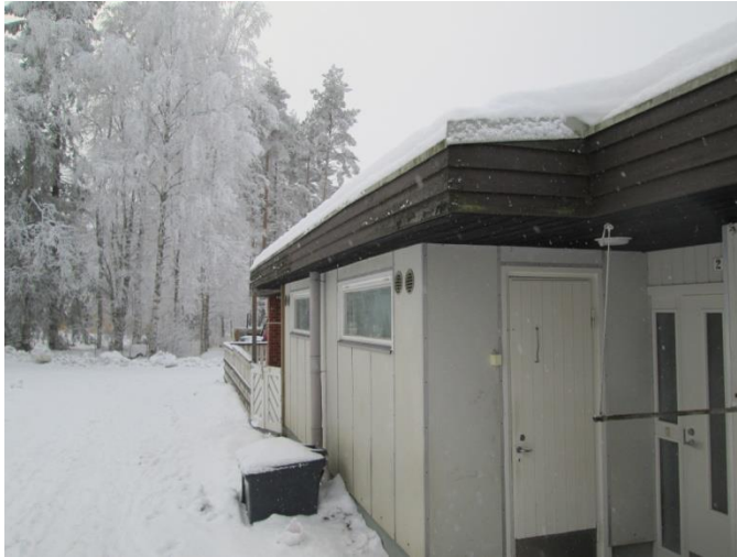
KUVA 30: Piiloräystäsrakenteen taipuminen A-rakennuksen itäjulkisivulla
