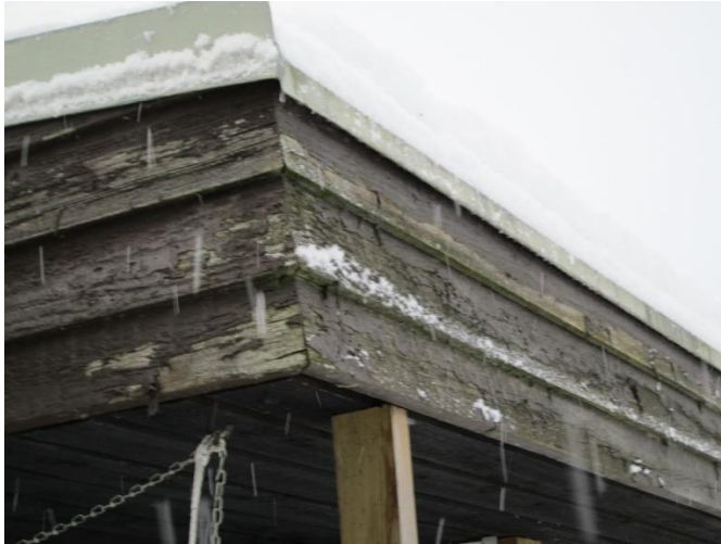
KUVA 27: Räystäsrakenteen maalivaurioita ja pinnassa kasvaa myös sammalta
