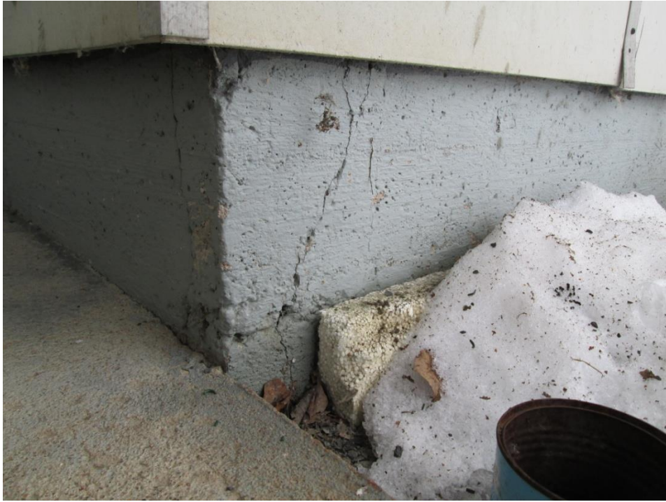
KUVA 6: Halkeama sokkelin kulmassa
