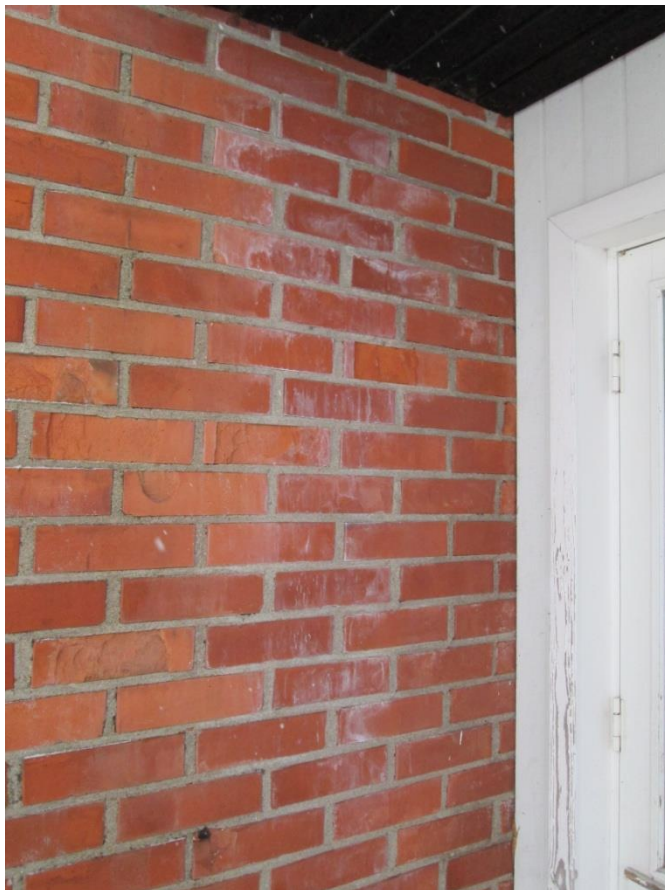
KUVA 10: Kosteusjälki tiilijulkisivussa ja tiilien pakkasrapautumia
