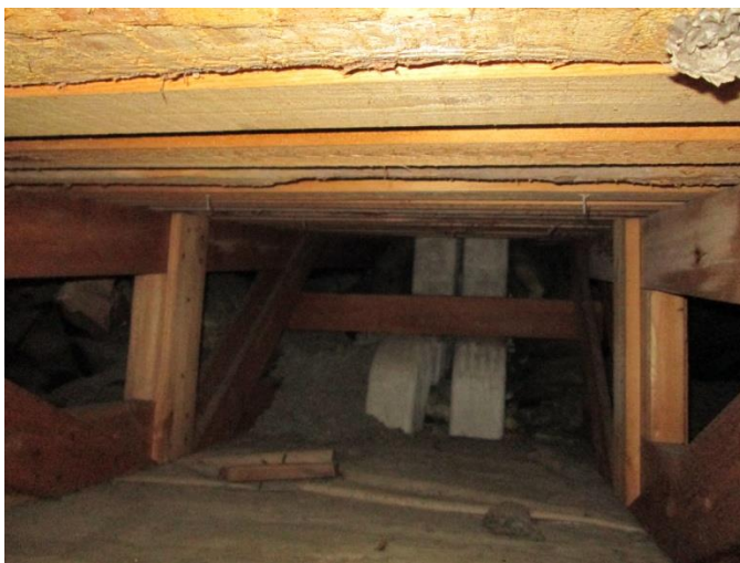
KUVA 26: Yläpohjan lisälämmöneriste ei ulotu reunoille asti
