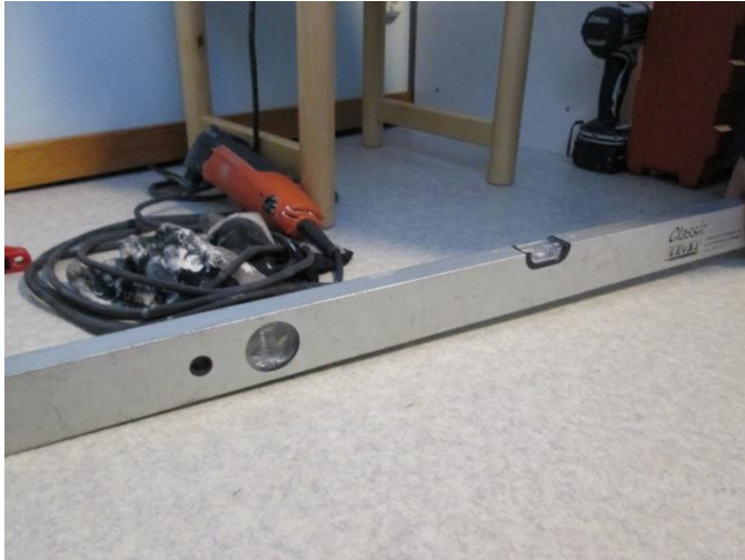
KUVA 12: Vesivaa'an avulla todetaan lattian painuneen metrin matkalla noin 1,5 cm
