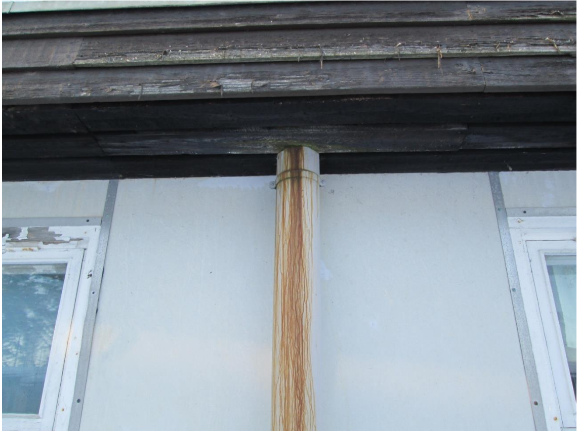
KUVA 34: Räystäslaudoissa on sammalta ja syöksytorven sekä kourun liitoskohta vuotaa
