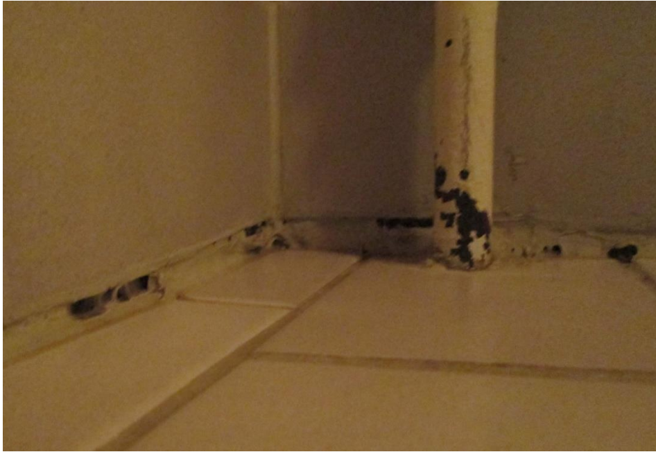
KUVA 43: Lattian ja seinän välisessä silikonisaumassa on reikiä.
