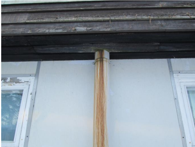
KUVA 16: Piilokourun ja syöksytorven liitokohta vuotaa
