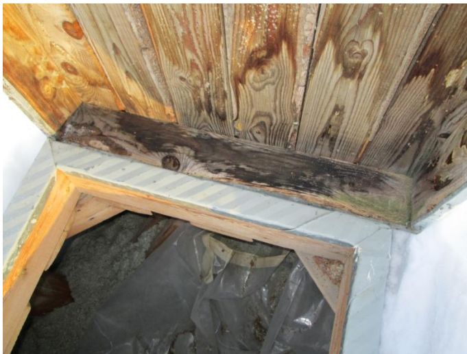
KUVA 24: Tarkastusluukun puuosien kosteusvaurio ja yläpohjassa ylimääräistä muovia
