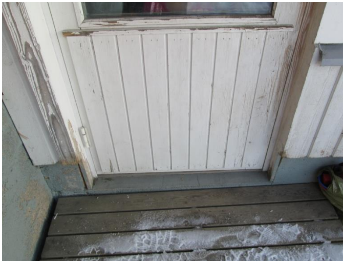
KUVA 41: Asunnon A4 ulko-ovessa pahoja maalivaurioita
