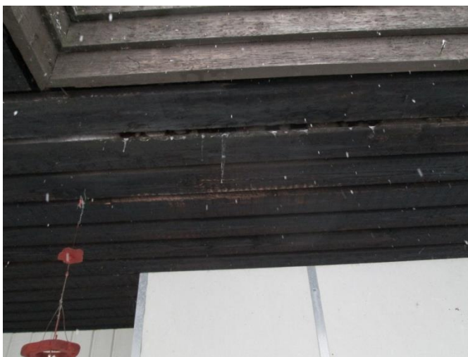
KUVA 29: Piiloräystään alalautojen välistä tulee jääpuikkoja A6 asunnon kohdalla
