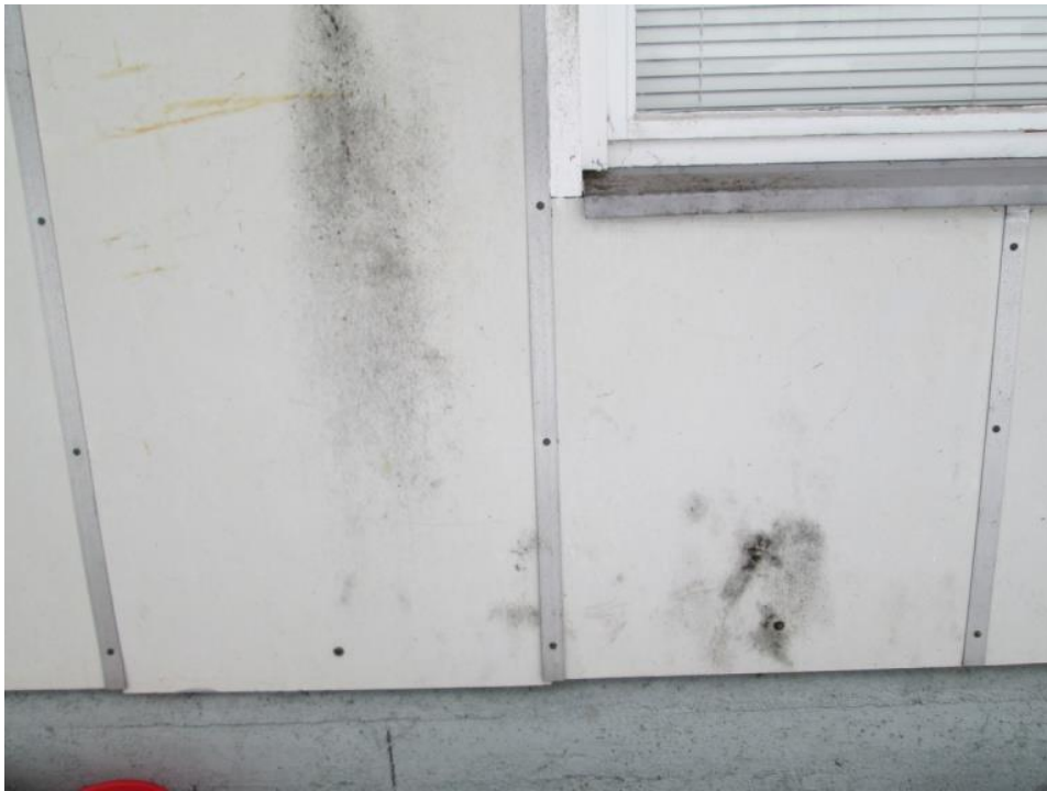
KUVA 12: Mineriittilevyissä on tummia homelaikkuja
