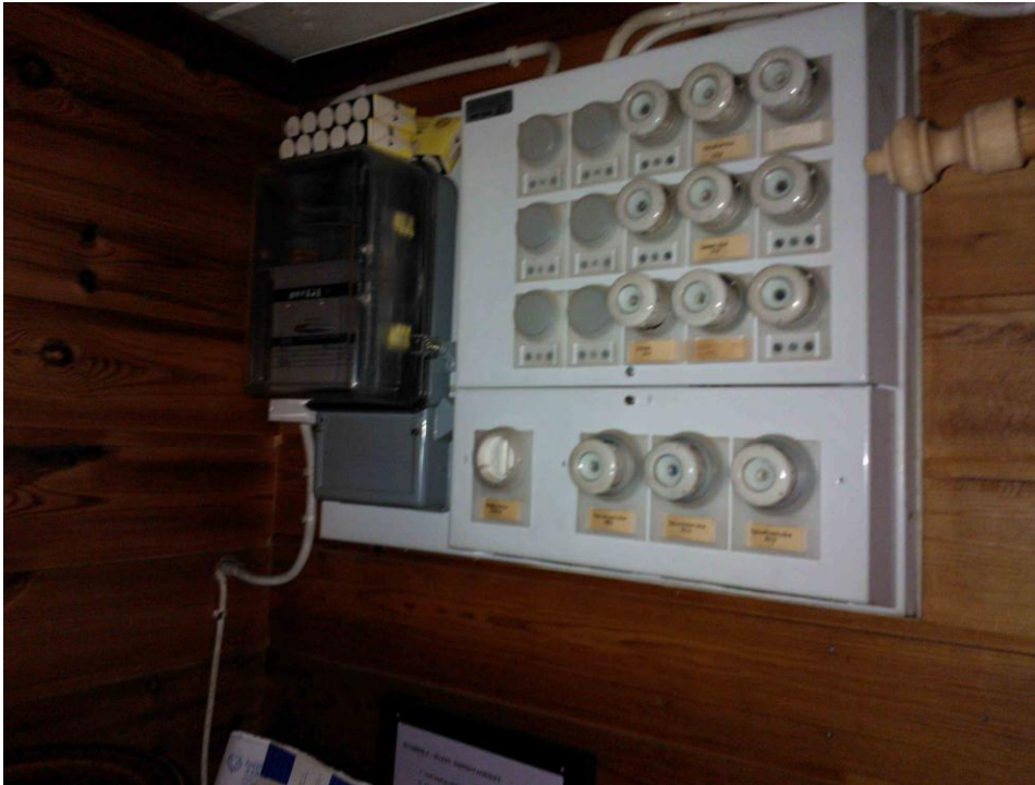
Kuva 30. Rakennuksissa käytössä olevat sähkönjakokeskukset
