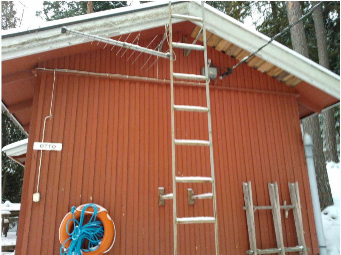
Kuva 8. Oikean puoleinen laudoitus puuttuu.
