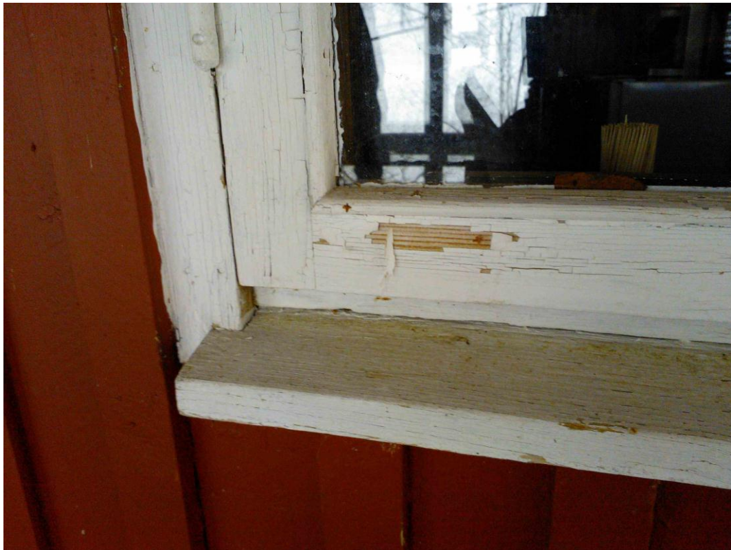
Kuva 13. Ikkunakarmien ja seinien maali hilseilee. (Lauri)
