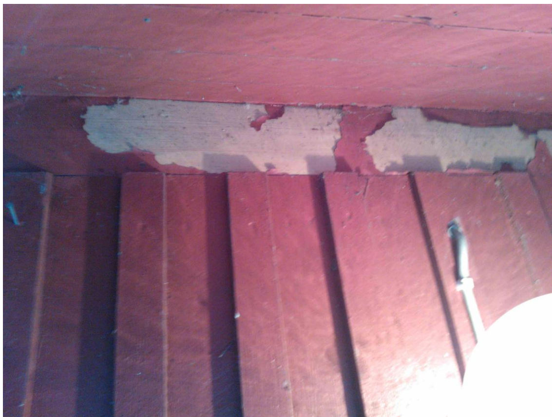
Kuva 4. Ulkoseinien maalipinta on irronnut lähes kokonaan.
