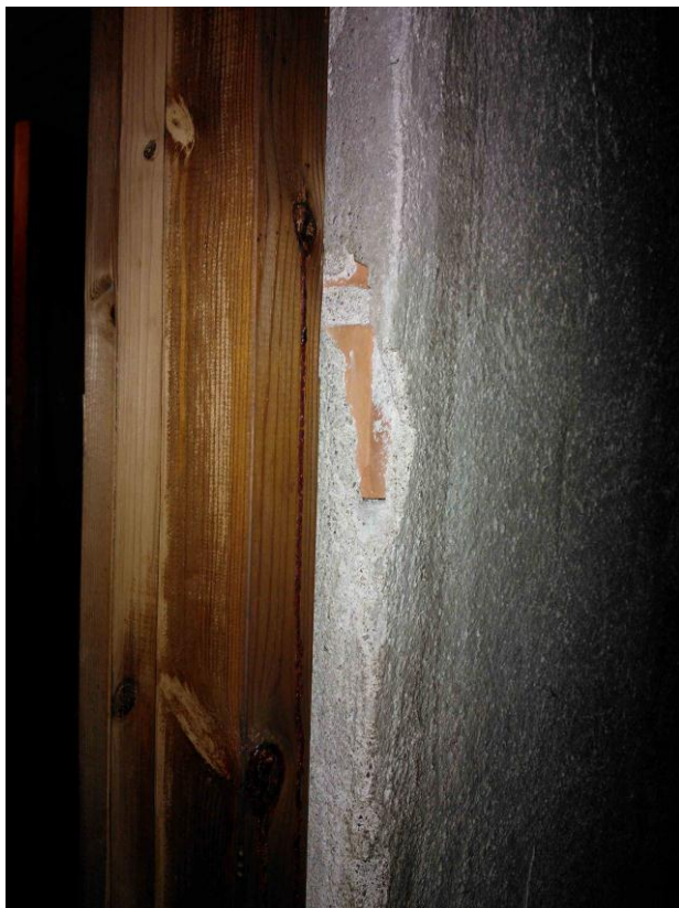
Kuva 23. Saunan ja pesuhuoneen rappaus on kulunut ja vaatii paikkausta
