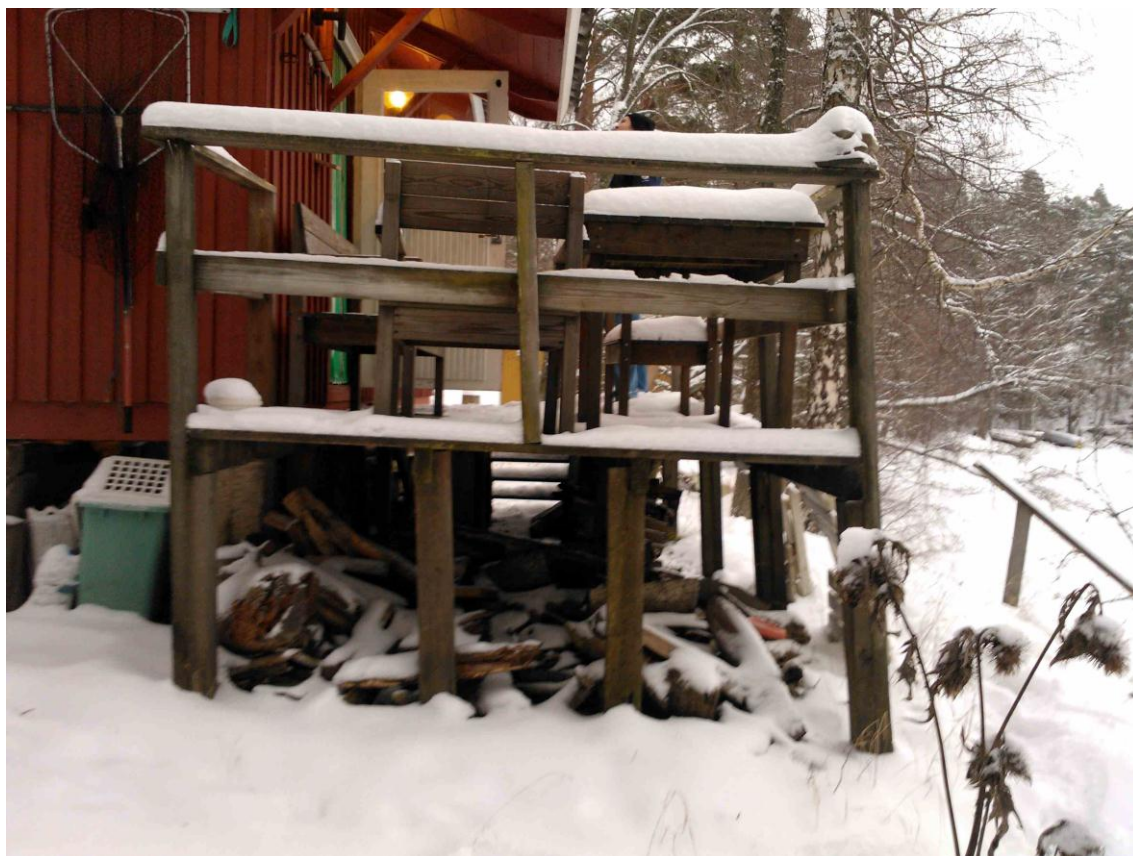
Kuva 7. Terassin tuenta on päässyt huonoon kuntoon.
