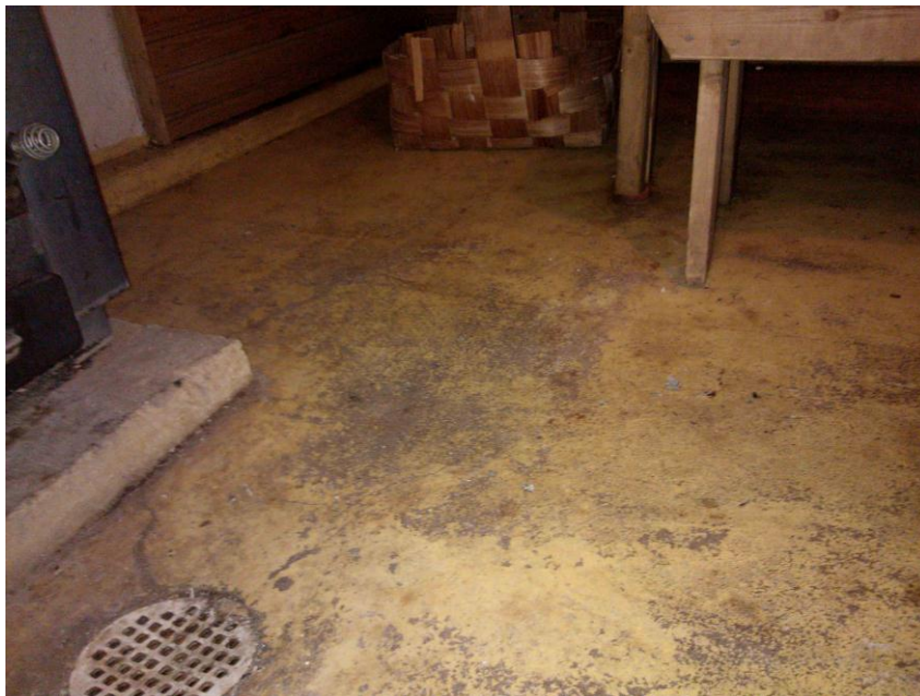
Kuva 22. Saunanlattiapinta on hyvin kulunut ja irtoilee jopa paloittain
