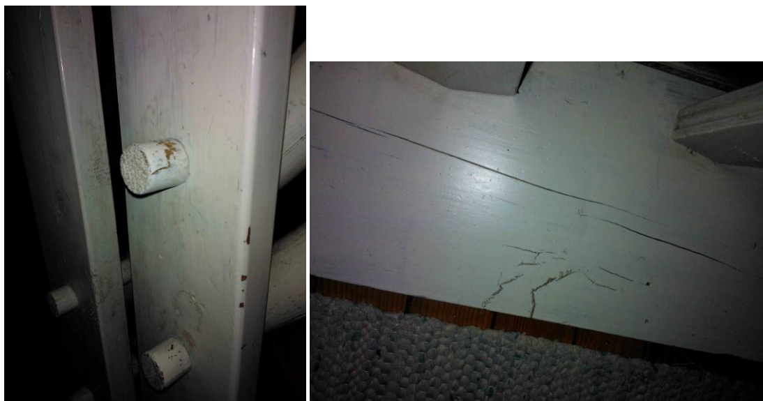
Kuva 15. Porraskaiteiden maalauksella saataisiin yleisilmettä siistiksi ja materiaali suojattua.
