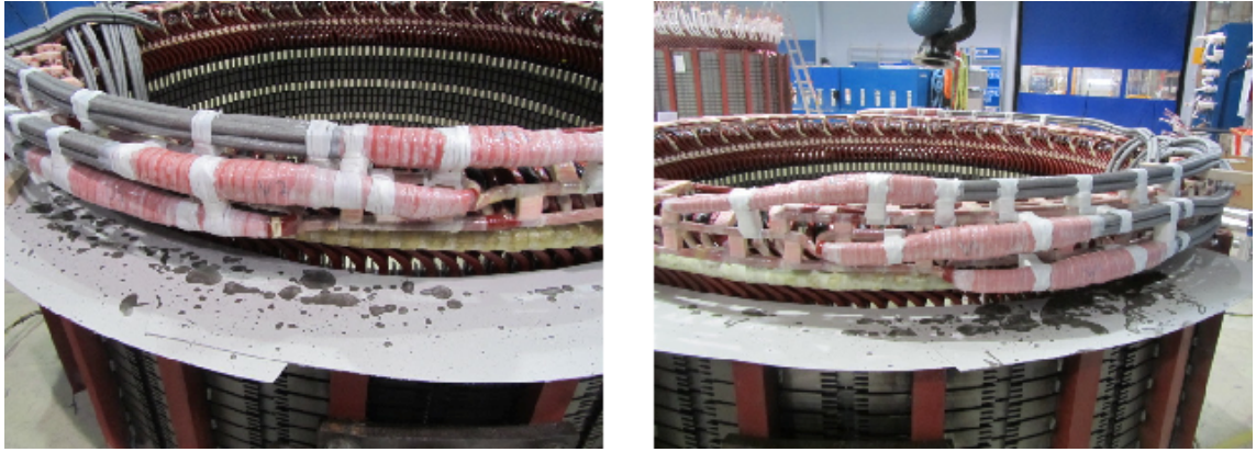
Kuva 34. Ilmakuivahartsatut kaapelit sekä puristusrenkaan suojaus
