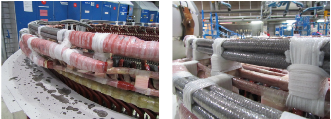
Kuva 33. Kaapeleiden eristys sekä niiden tuenta kytkentärenkaistoon
