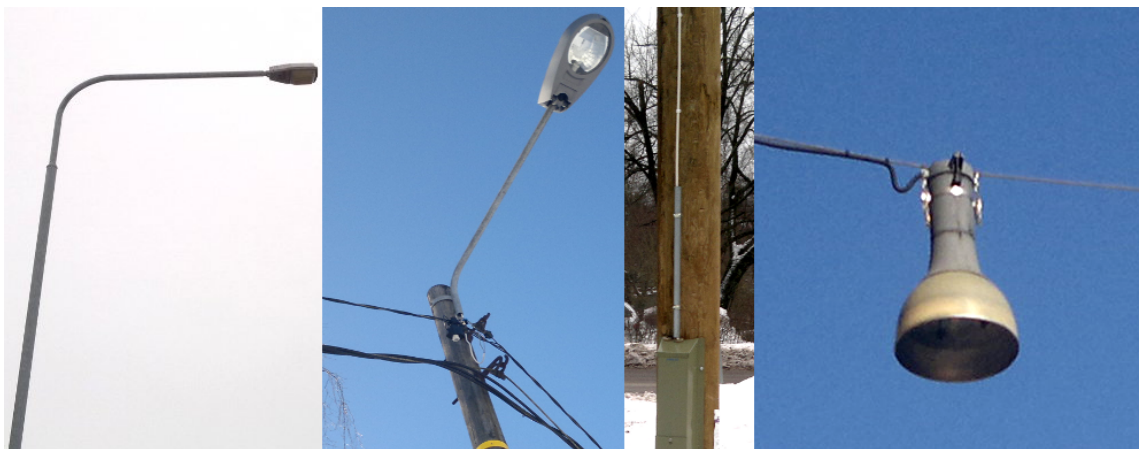
KUVA 6. Valaisimen johdotusvaihtoehdot (kuvattu 31.1.2013)
