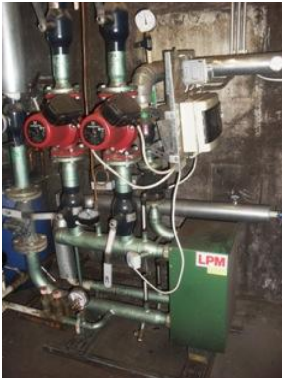
Kuva 4.1.3. Vastaanottoaseman lämmönsiirrin (Olli-Pekka Vanhala)
