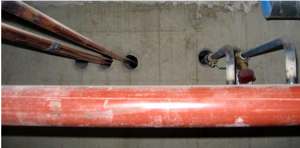
KUVIO 4. Rappukäytävän ja huoneiston väliset läpiviennit ilman palokatkotuotteita
