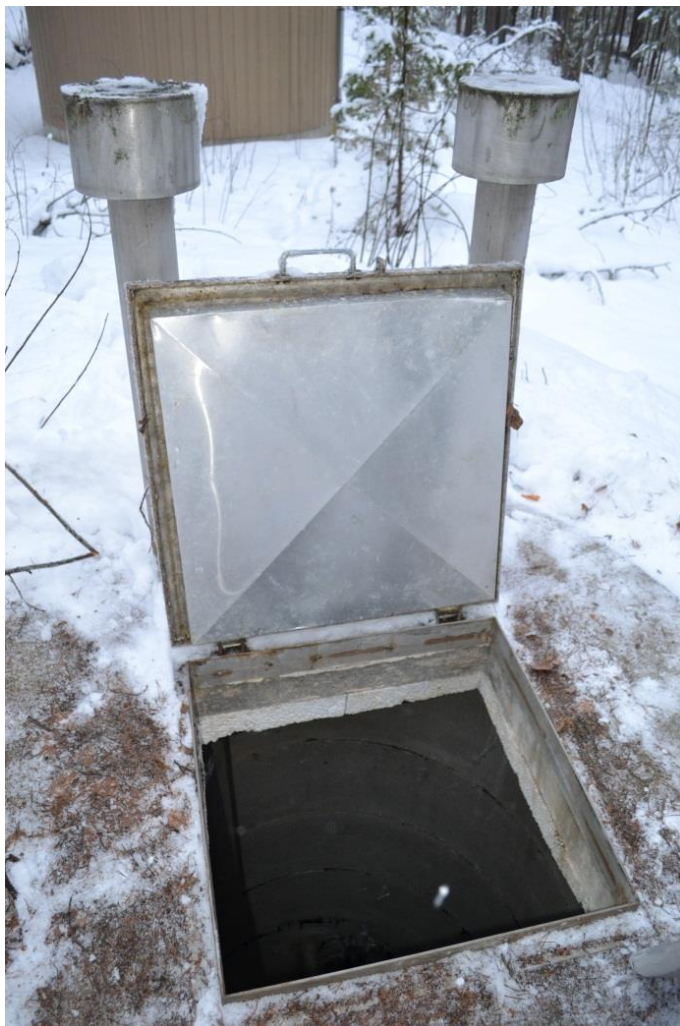
Kuva 6 Huoltoluukku ja tuuletusputket (Kosunen 9.1.2013.)
