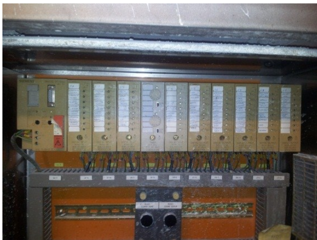
KUVA 3. Siemens S5 110U-logiikka
