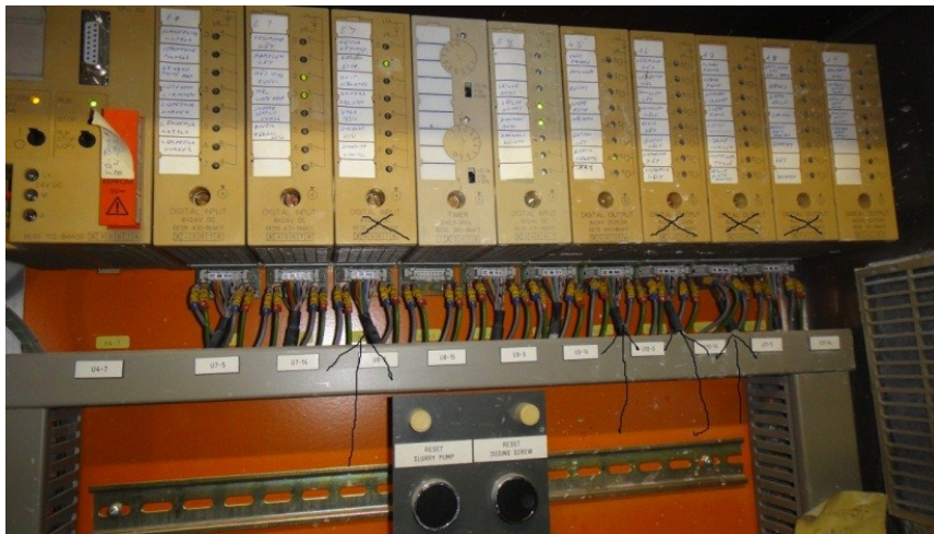
KUVA 30. Purettava logiikka ja kaapin oveen menevät kaapelit
