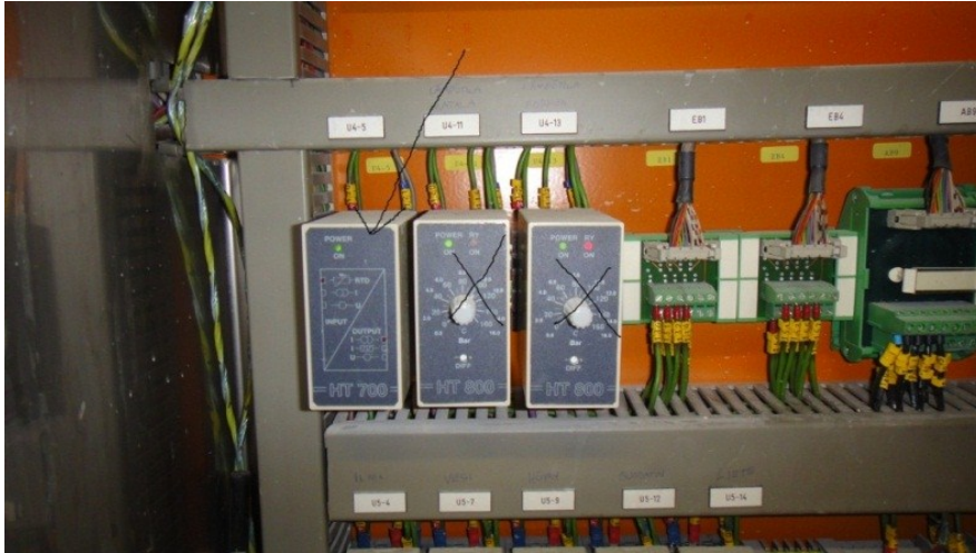
KUVA 33. Mittamuunnin U4-5 ja rajareleet U4-11/13
