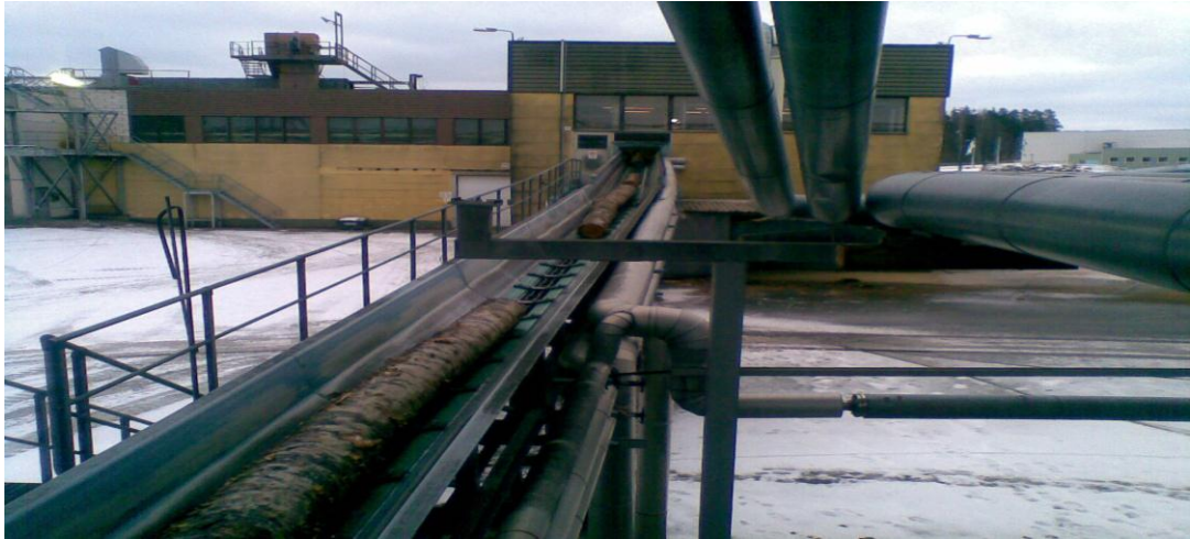
Kuva 8. Vaneritehtaan tukkien syöttölinja.
