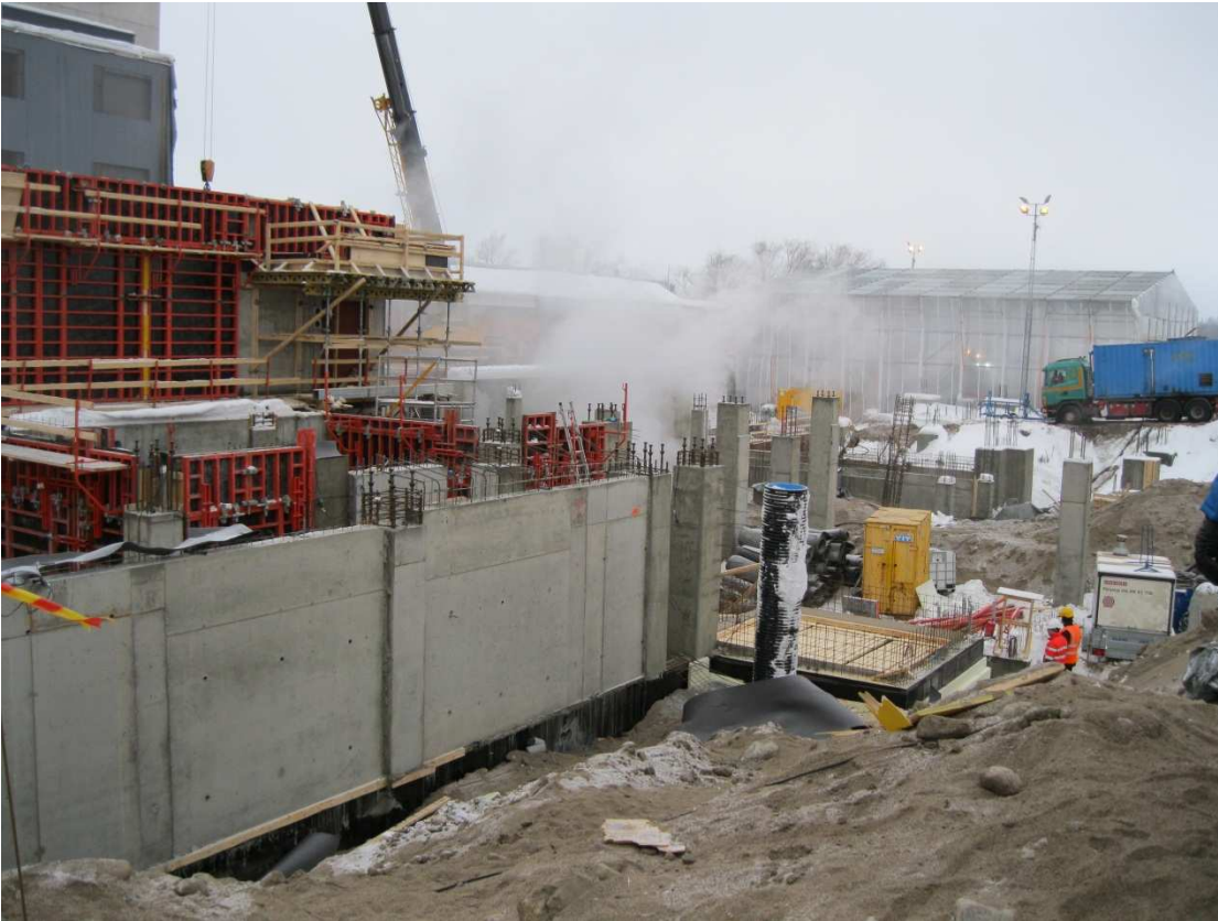
Kuva 2. Kuvaa työmaalta ennen rakennusurakan alkamista. Muoteissa olevat telineet ovat puutteelliset ja tikkaita käytetty työskentelyyn. Kuva Marko Savolainen 2012.
