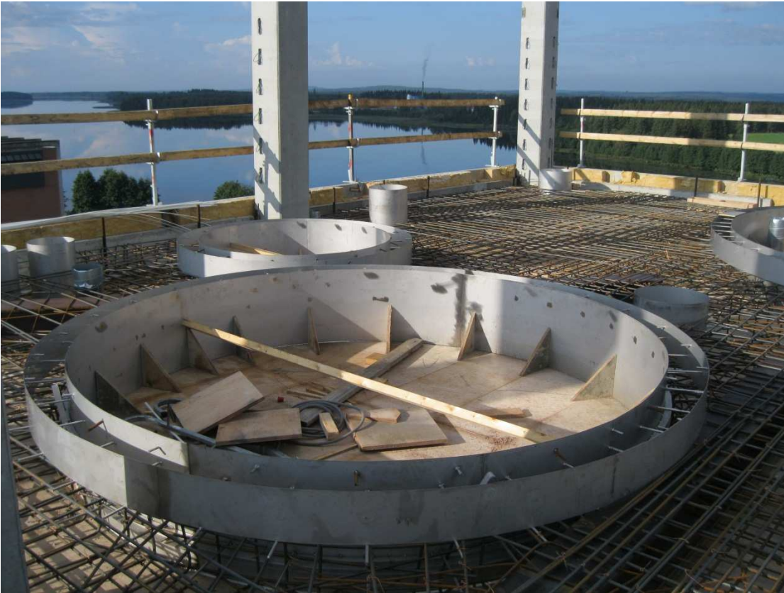
Kuva 6. Haalausaukkoja muottivaiheessa, aukosta pudotusta kymmeniä metrejä pu- toamissuojaus on tehtävä huolellisesti. Kuva Marko Savolainen 2012.
