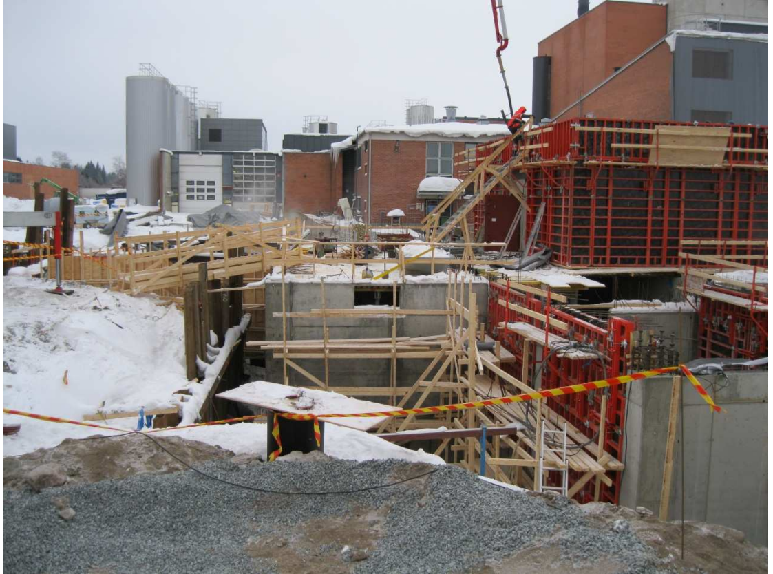
Kuva 1. Työmaa ennen rakennusurakan alkamista, vaikuttaa erittäin sekavalta ja työturvallisuusnäkökohta on jäänyt lähes täysin huomiotta. Kuva Marko Savolainen 2012.
