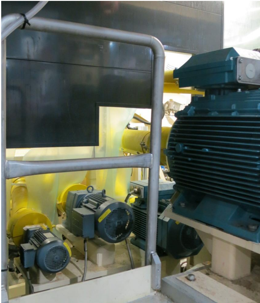
KUVA 6. Silikoniaseman moottorit sekä suojaus (Kuva: Krista Hupanen 2013)
